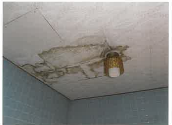
雨漏り痕の状況(洗面所の天井)
