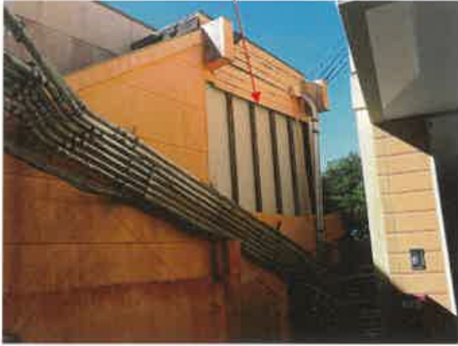
物件 19 建物壁面の崩落状況
