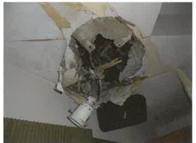
客室天井の崩落状況
