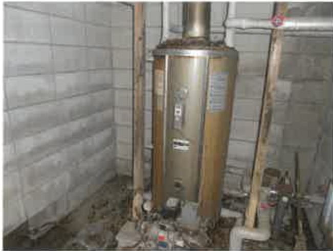
ボイラー室内部
