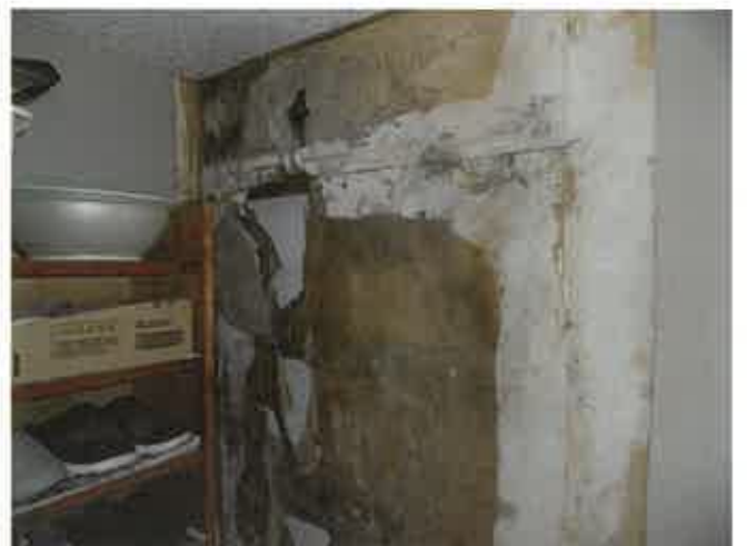
壁面の朽廃状況(リネン室)
