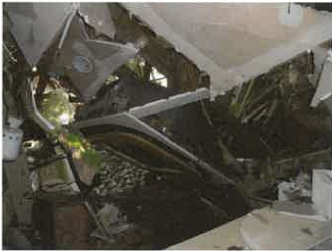
客室 (崩落状況)
