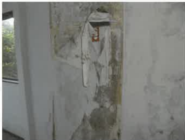
壁面の崩落状況
