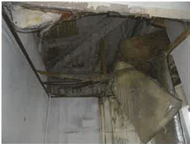
天井の崩落状況
