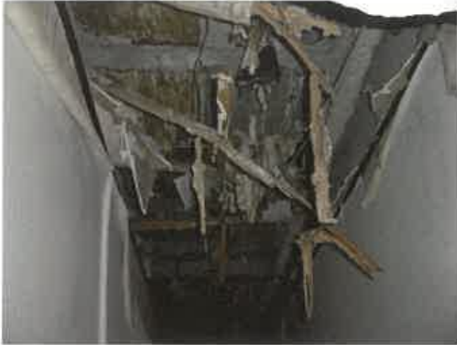
天井の崩落状況
