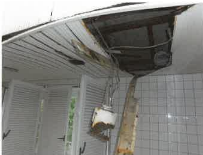
客室天井の崩落状況
