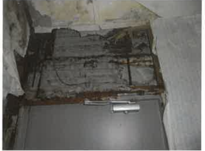
玄関壁面の崩落状況
