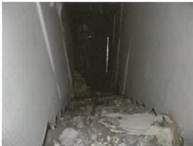
階段天井の崩落状況
