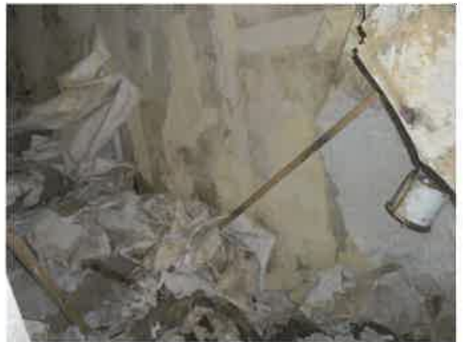
階段壁面の崩落状況
