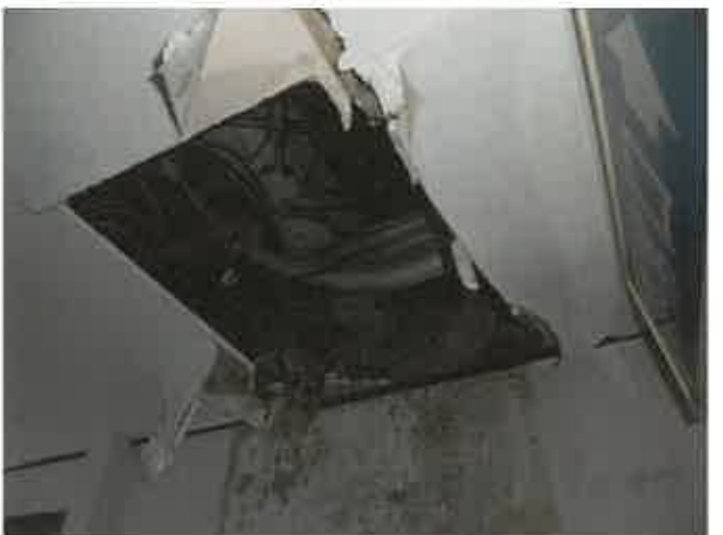
天井の崩落状況
