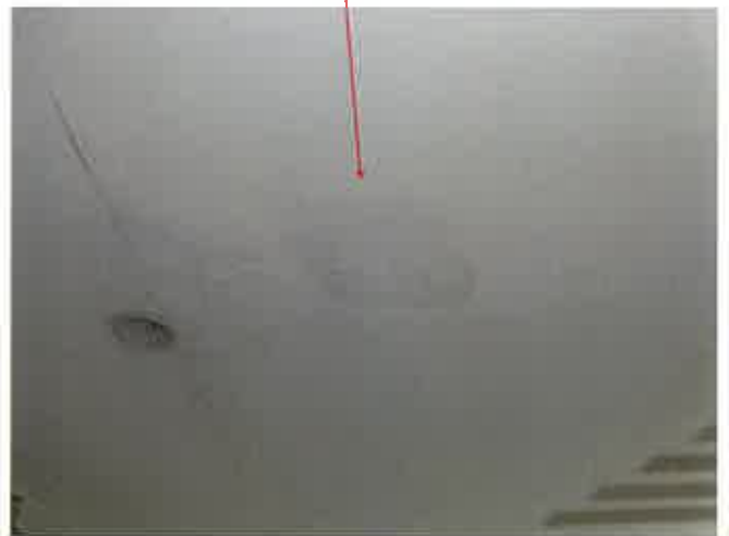
更衣室天井の雨漏り痕
