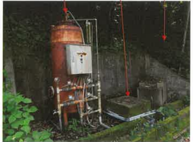
浄化装置制御盤 浄化槽 物件 6
