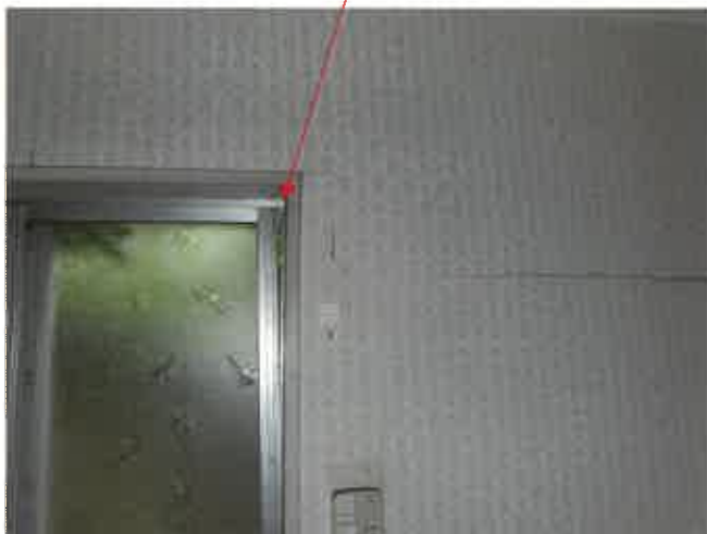
窓枠が傾いている状況(旧厨房)
