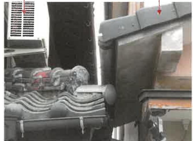
隣地建物 軒が重なった状況 物件 2 主
