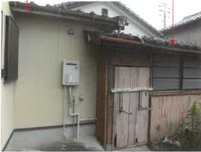
物件2主 両建物の接合状況 物件2符1
