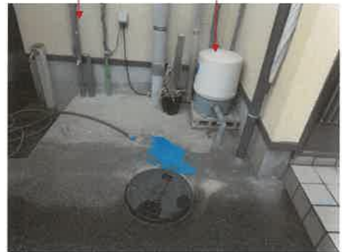
物件 2 主 井戸用ポンプ
