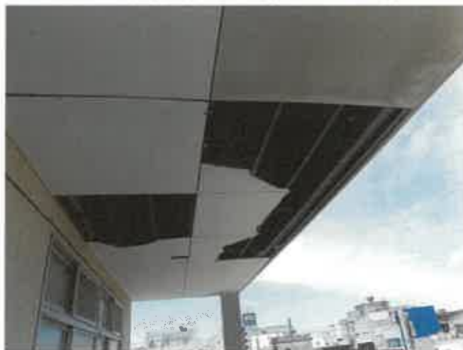
天板の損傷状況(バルコニー)
