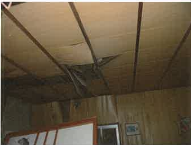
天井の損傷状況(和室)
