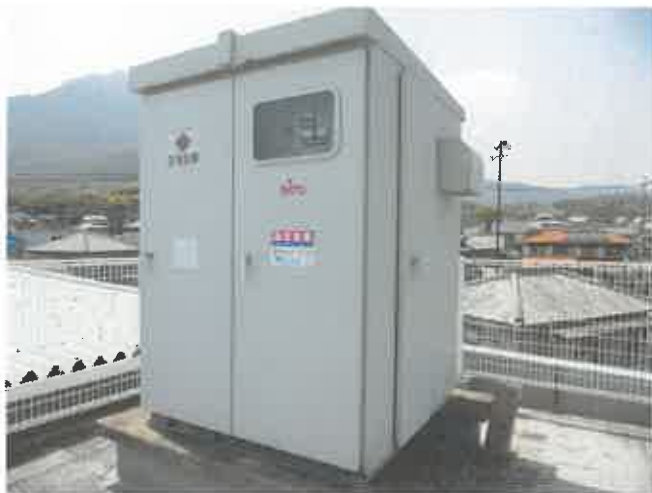
変電設備(屋上)
