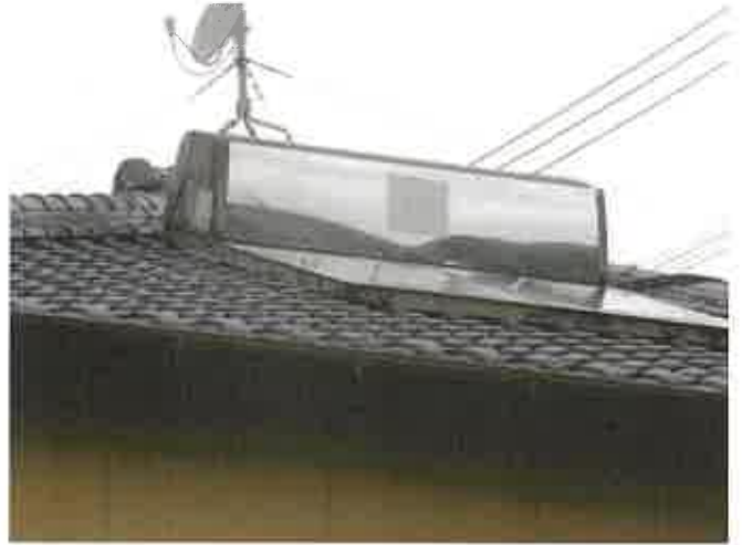
太陽熱温水器の固着状況
