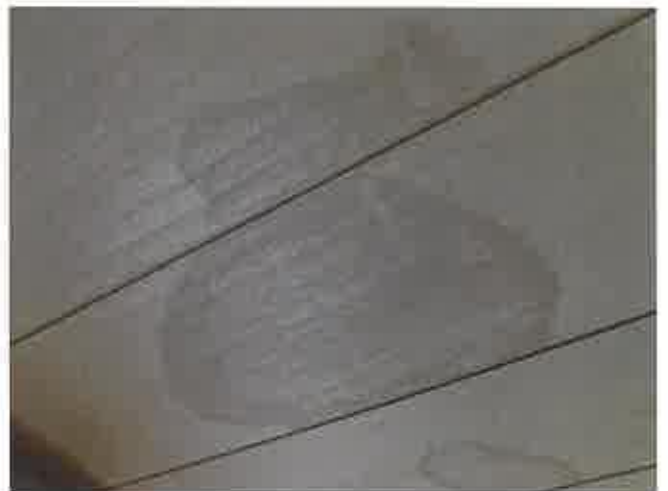
雨漏り痕の状況(リビング天井)
