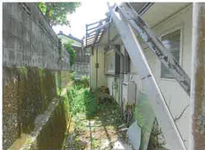
窓ガラスが割れたサッシ
