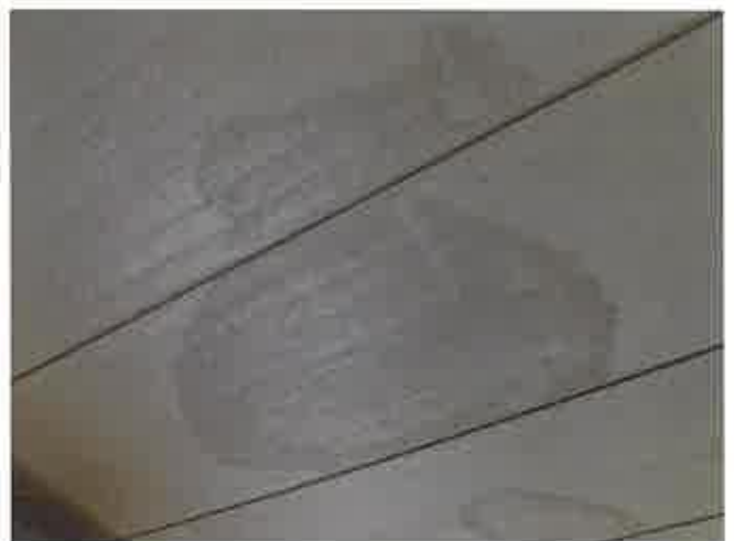
雨漏り痕の状況(リビング天井)
