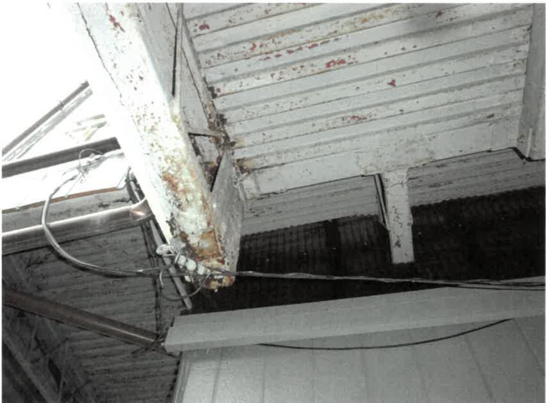
物件2（主である建物） 2階部分床下鉄部の錆び
