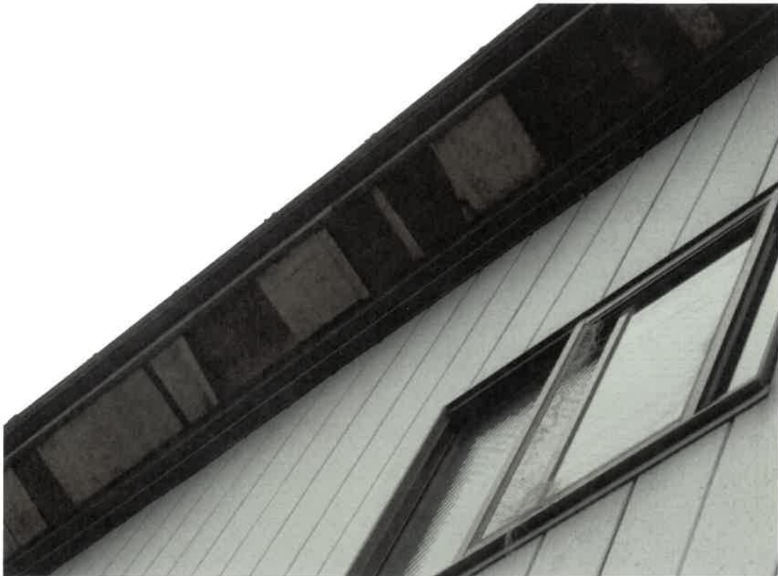
物件2（主である建物） 2階軒裏の状態
