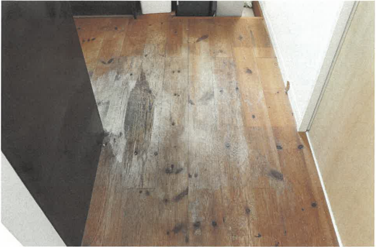
フローリングの傷み（1階；キッチン周辺）
