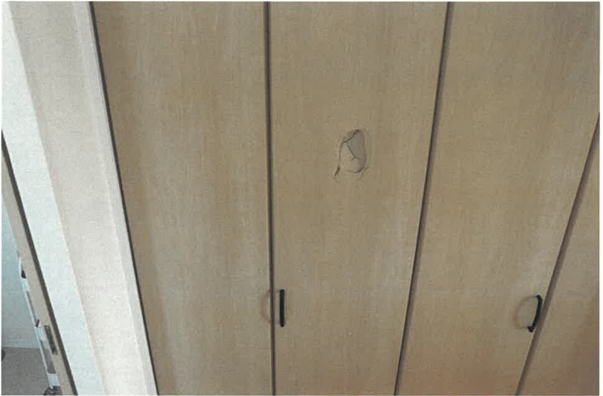
扉の損傷（1階；物入）
