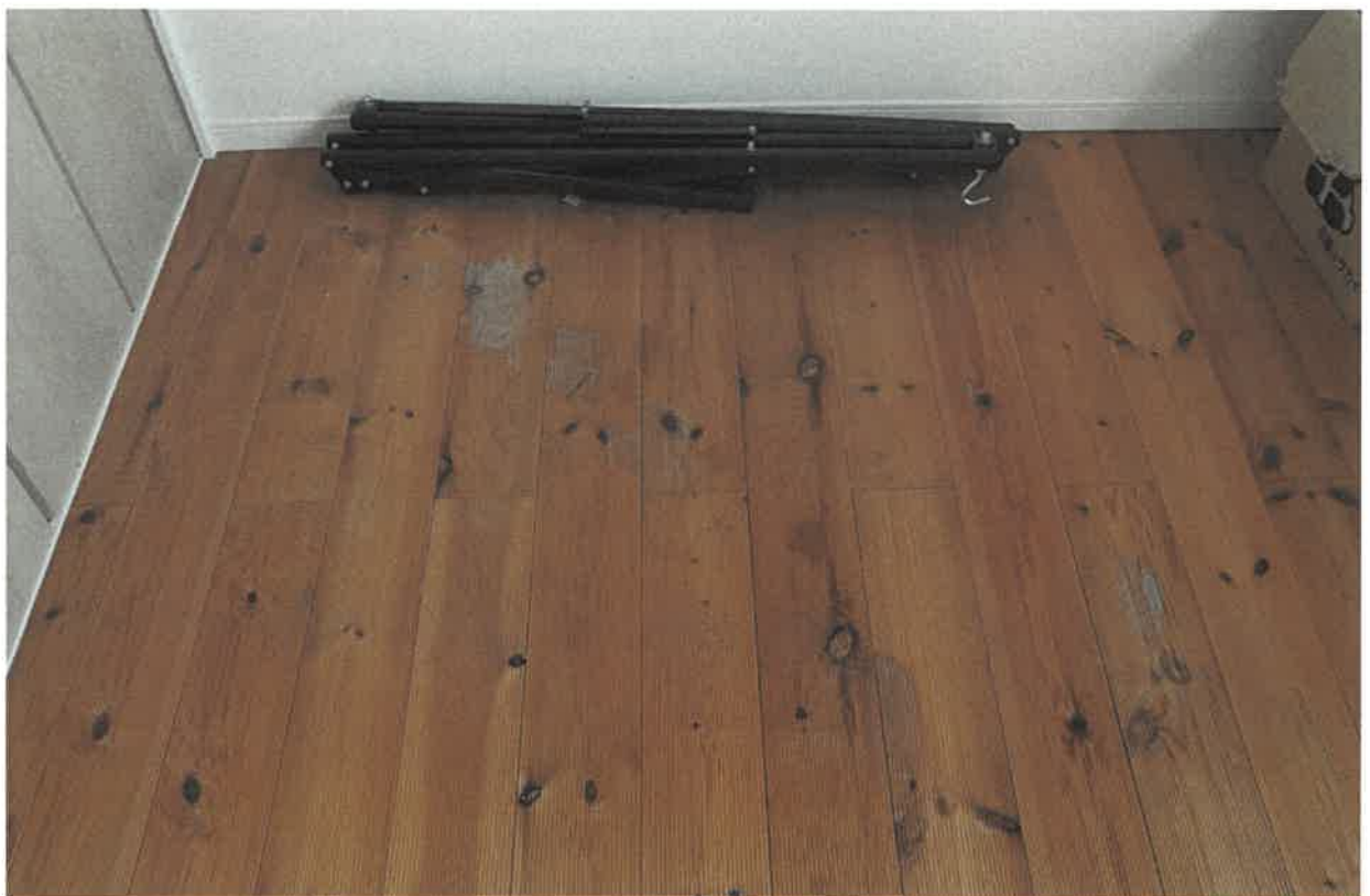
フローリングの傷み（2階；洋室③）
