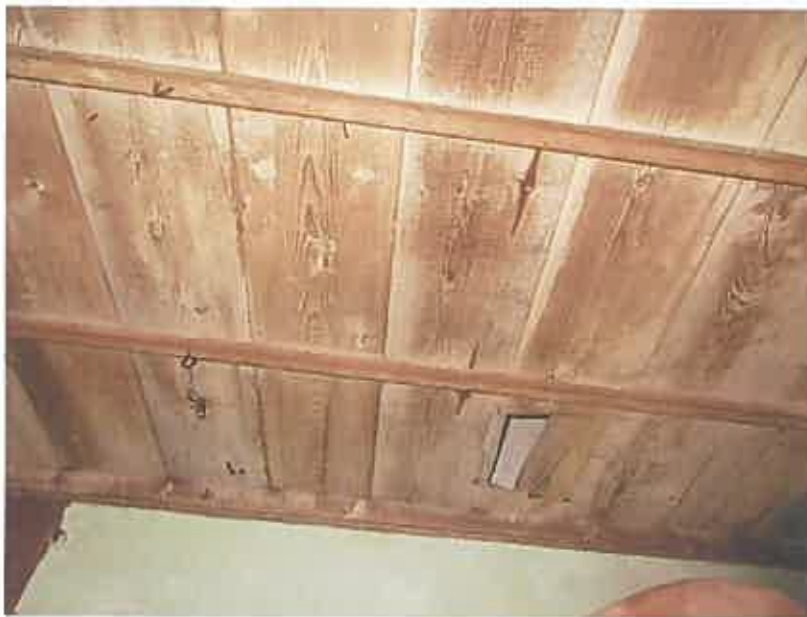
物件 2 天井の破損
