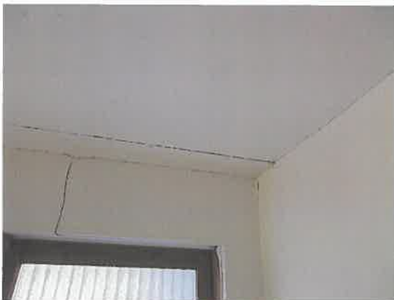
物件 2 内壁のクラック
