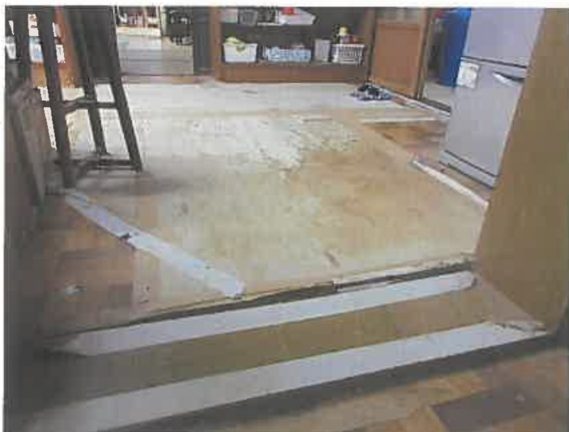
物件 2 床の破損
