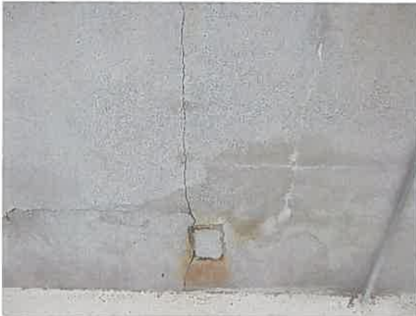
物件 2 外壁のクラック
