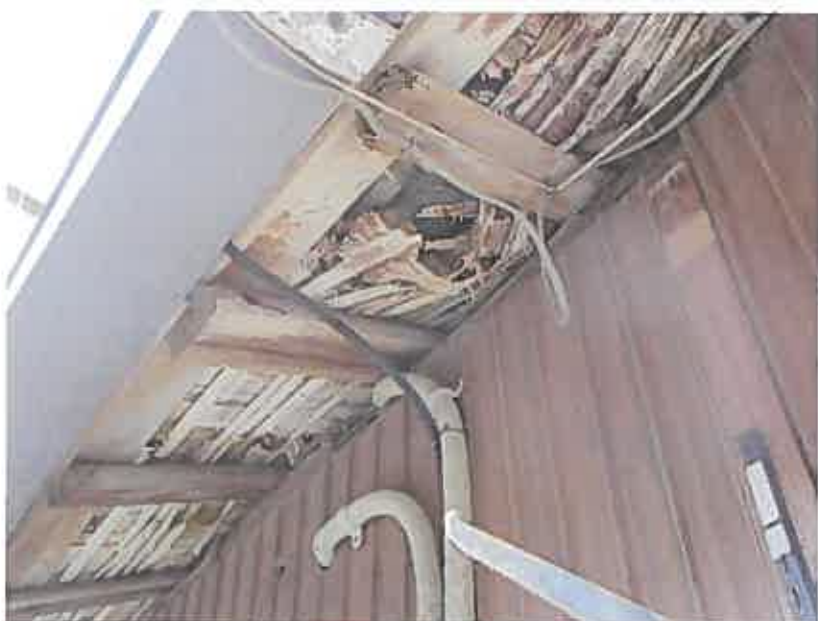
物件 2（附属建物） 軒裏の損壊
