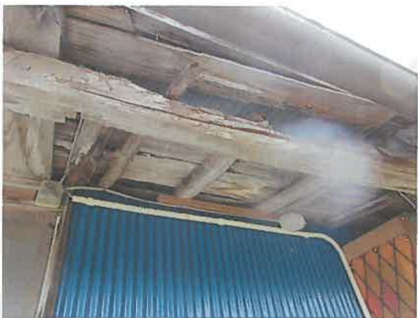
物件 2（附属建物） 軒裏の損壊
