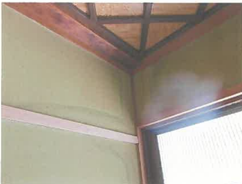
物件 4 内壁の雨染み
