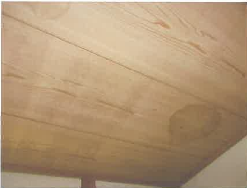
物件 4 天井の雨染み
