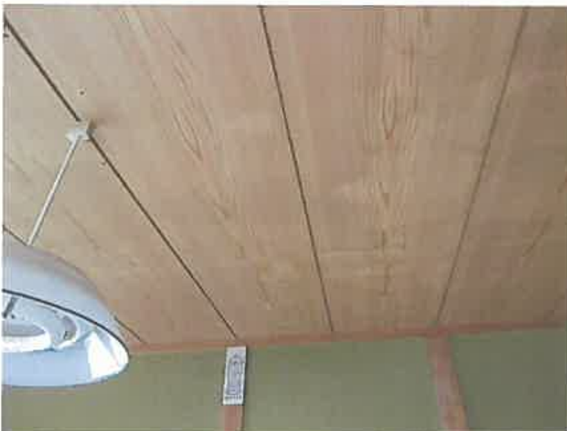
物件 4 天井の雨染み
