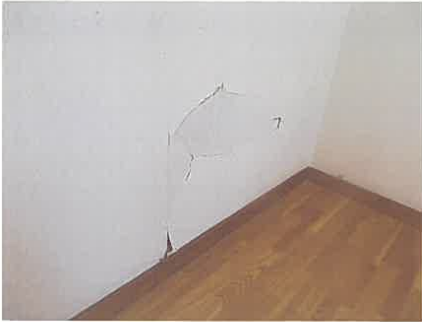
物件 4 内壁の破損
