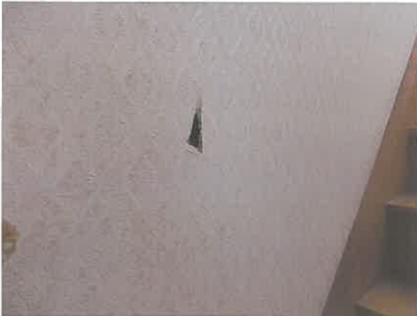
物件 4 内壁の破損
