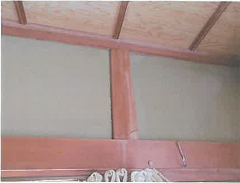
物件 4 内壁の雨染み
