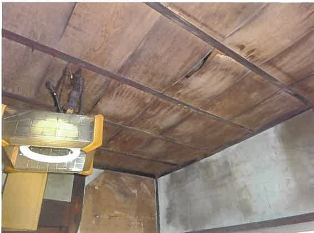
物件2（主である建物）内部 1階和室の漏水による劣化箇所
