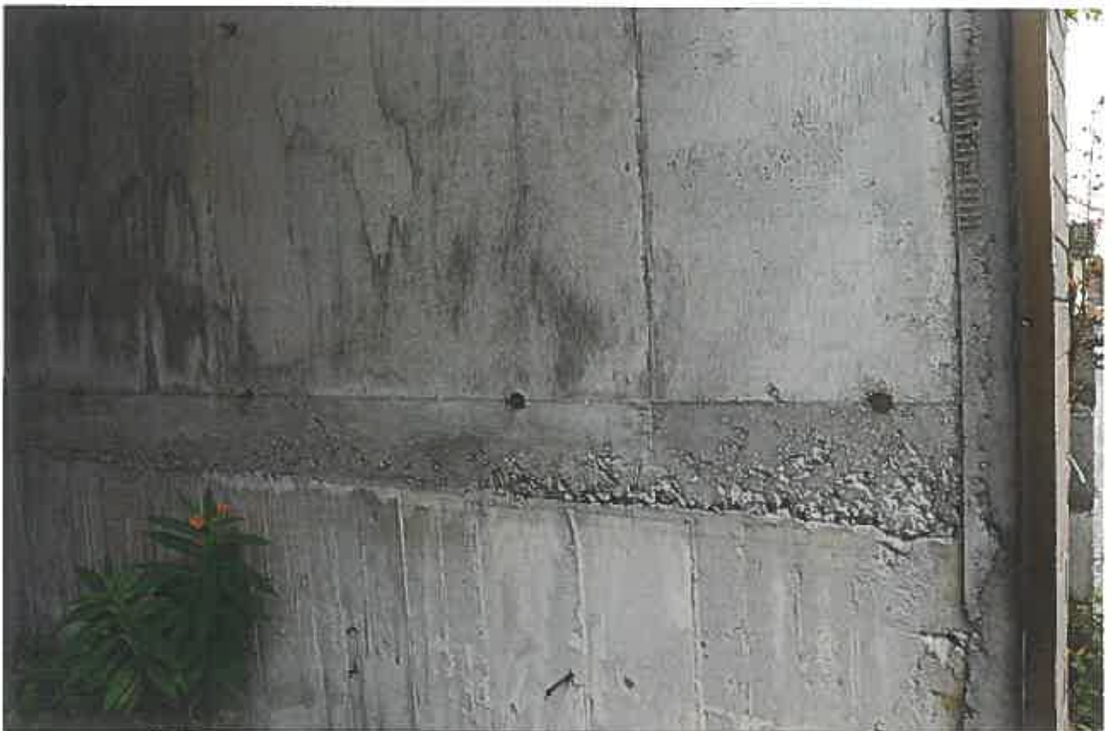
1階車庫；コンクリート施工不良（ジャンカ/コールドジョイント）
