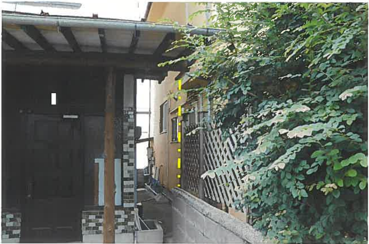
西側建物（玄関庇）からの被越境状況
