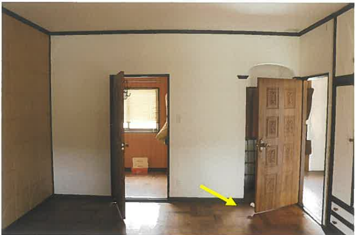
床の傾き（3階；洋室）
