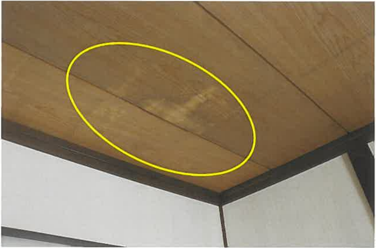
天井の雨染み（3階；和洋室）
