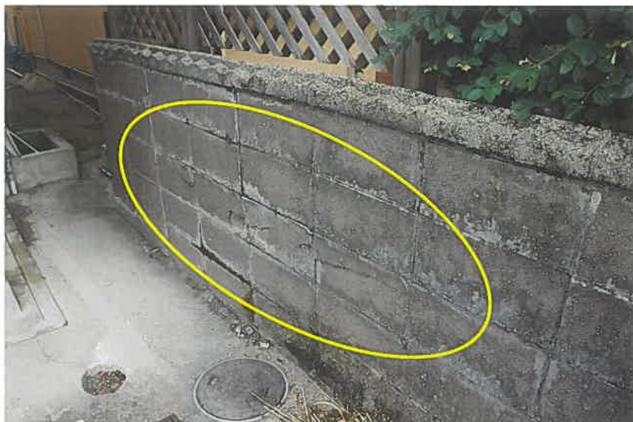
西側ブロック塀の亀裂・破断
