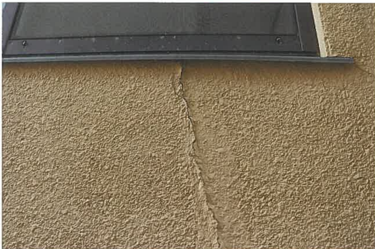
西側外壁の亀裂補修痕（洗面所・浴室附近）
