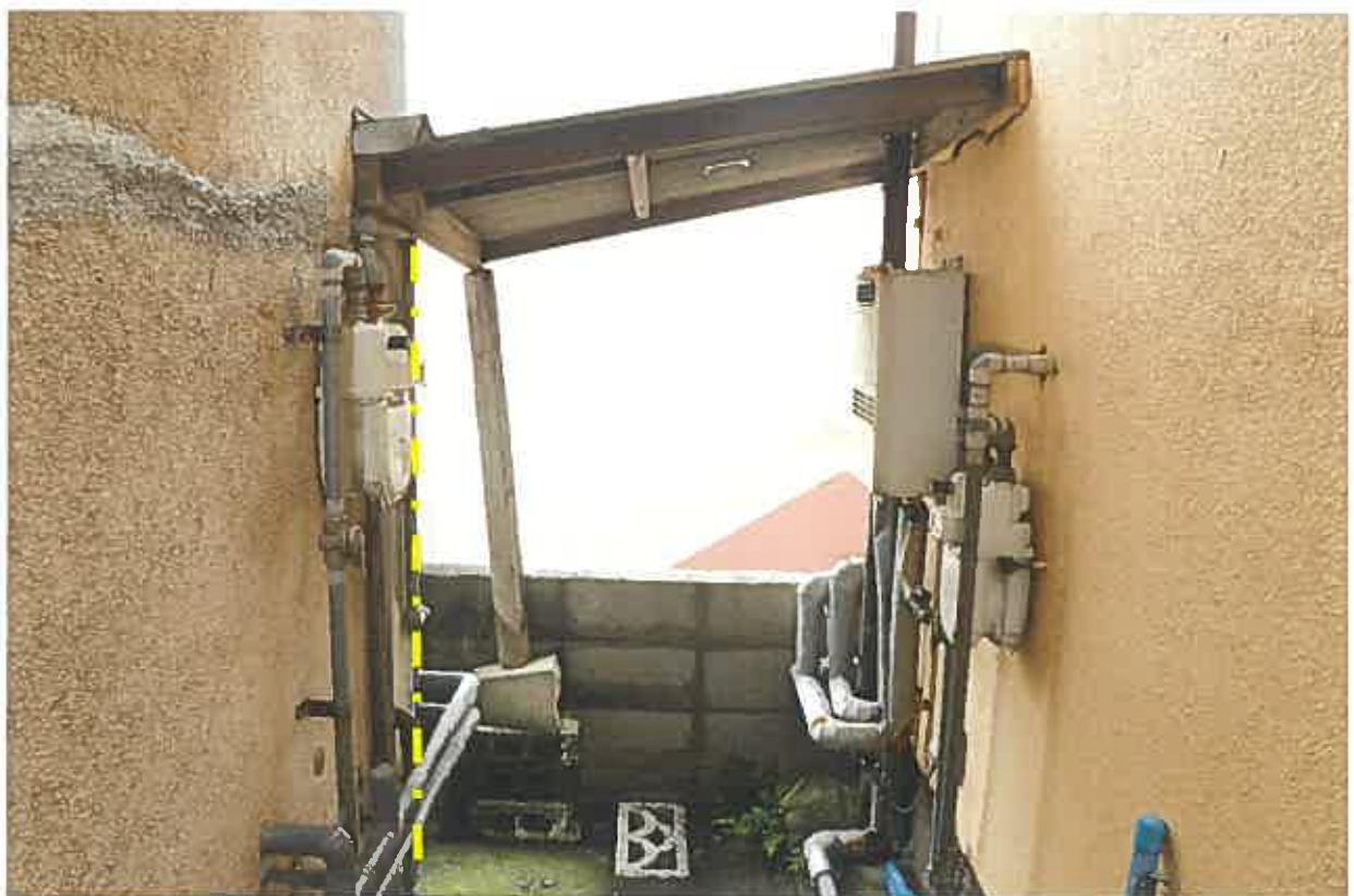
西側隣接地への越境状況（ガス給湯器・温泉引湯管の兼用庇）
