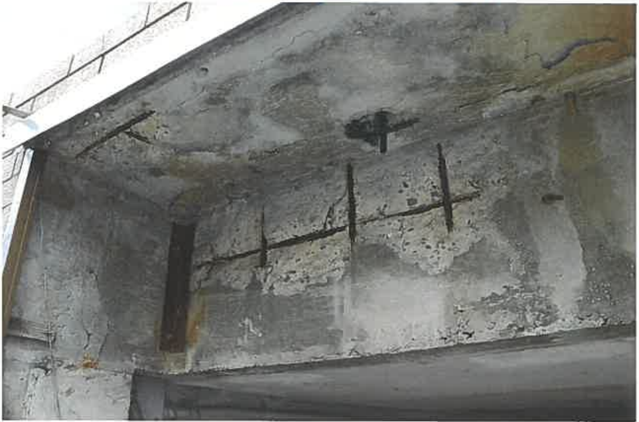
1階車庫；内部鉄筋腐食に伴うコンクリート爆裂
