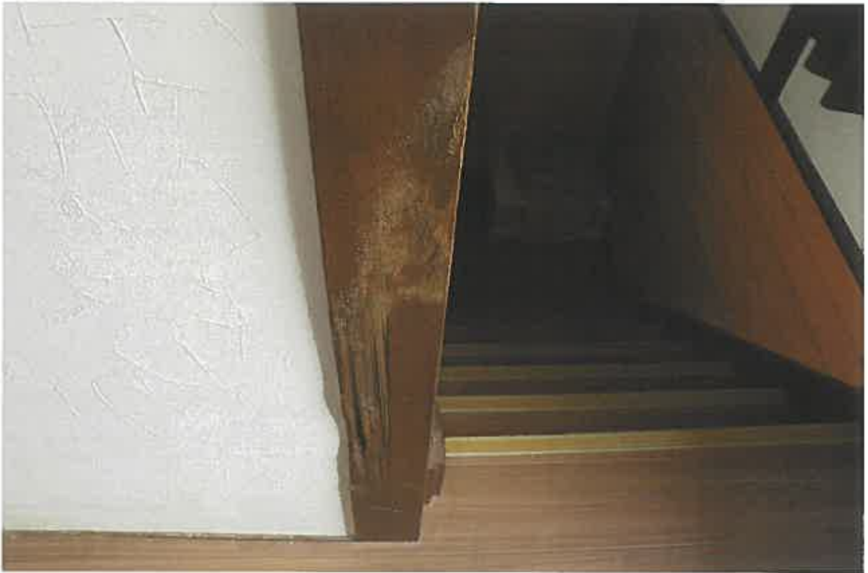
柱の損傷（3階；階段）
