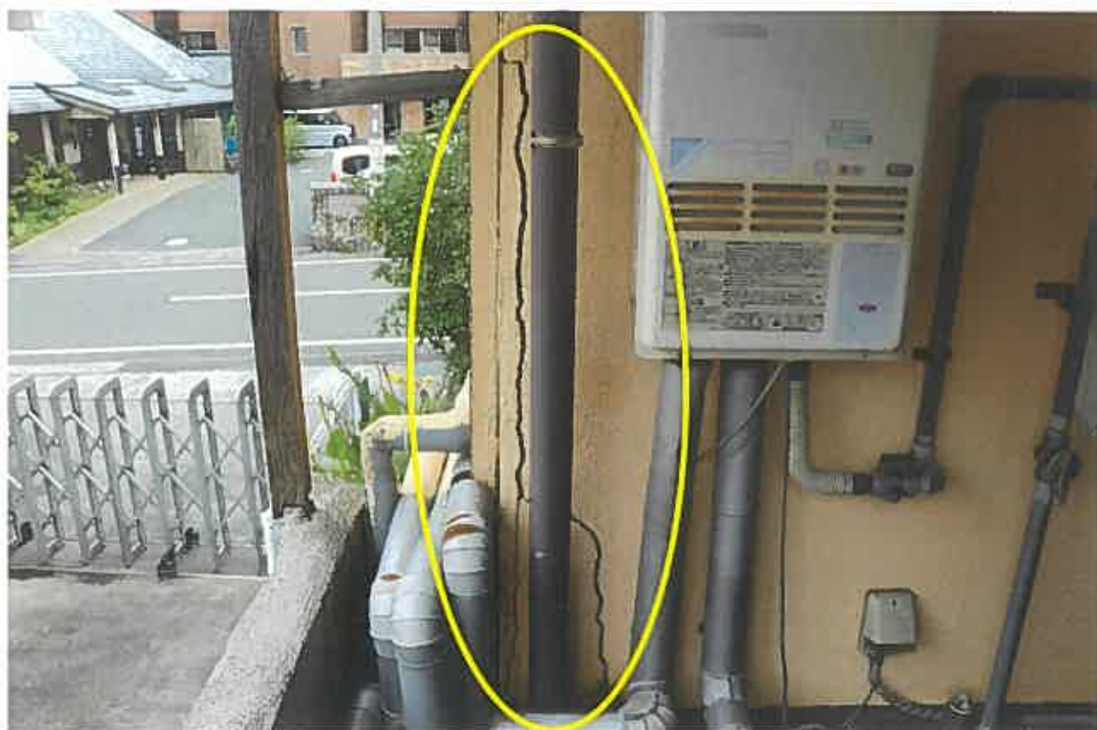
西側外壁の破断状況（浴室附近）
