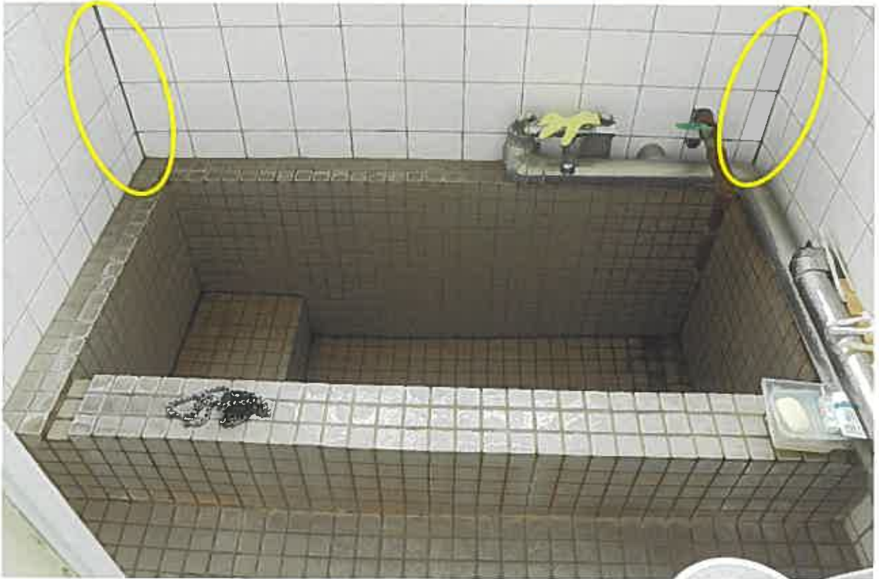
タイル壁の破断 (2階浴室)
