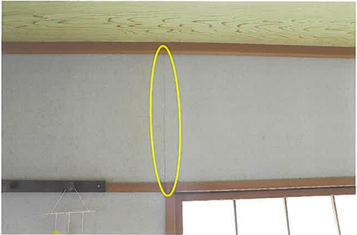
壁の亀裂（1階・和室）
