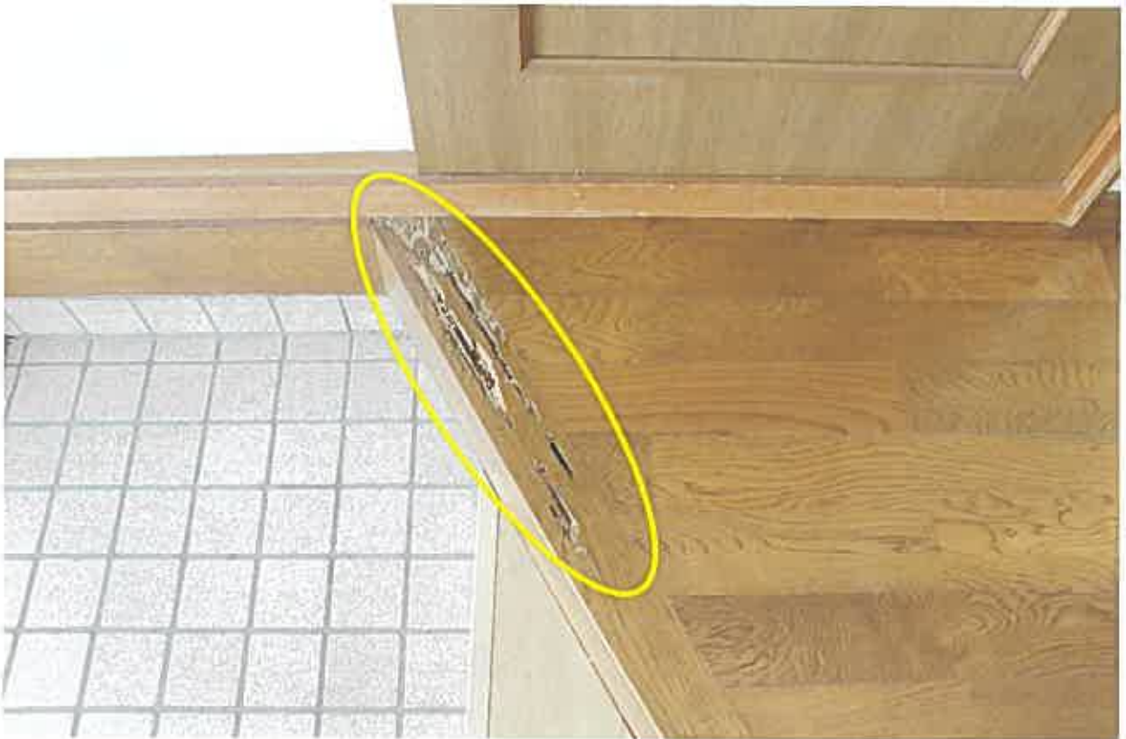
白蟻被害箇所（玄関上がり框）
