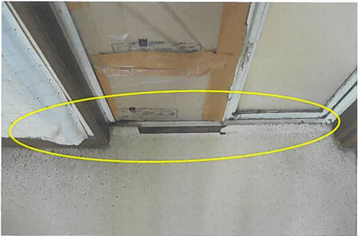
浴室扉の破損・床の腐食（1階・脱衣所）
