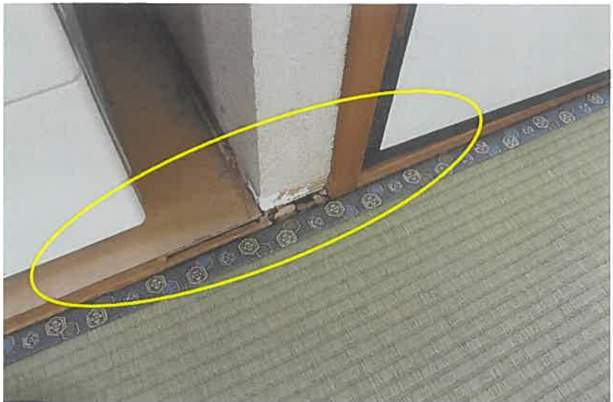
白蟻被害箇所（1階・和室）
