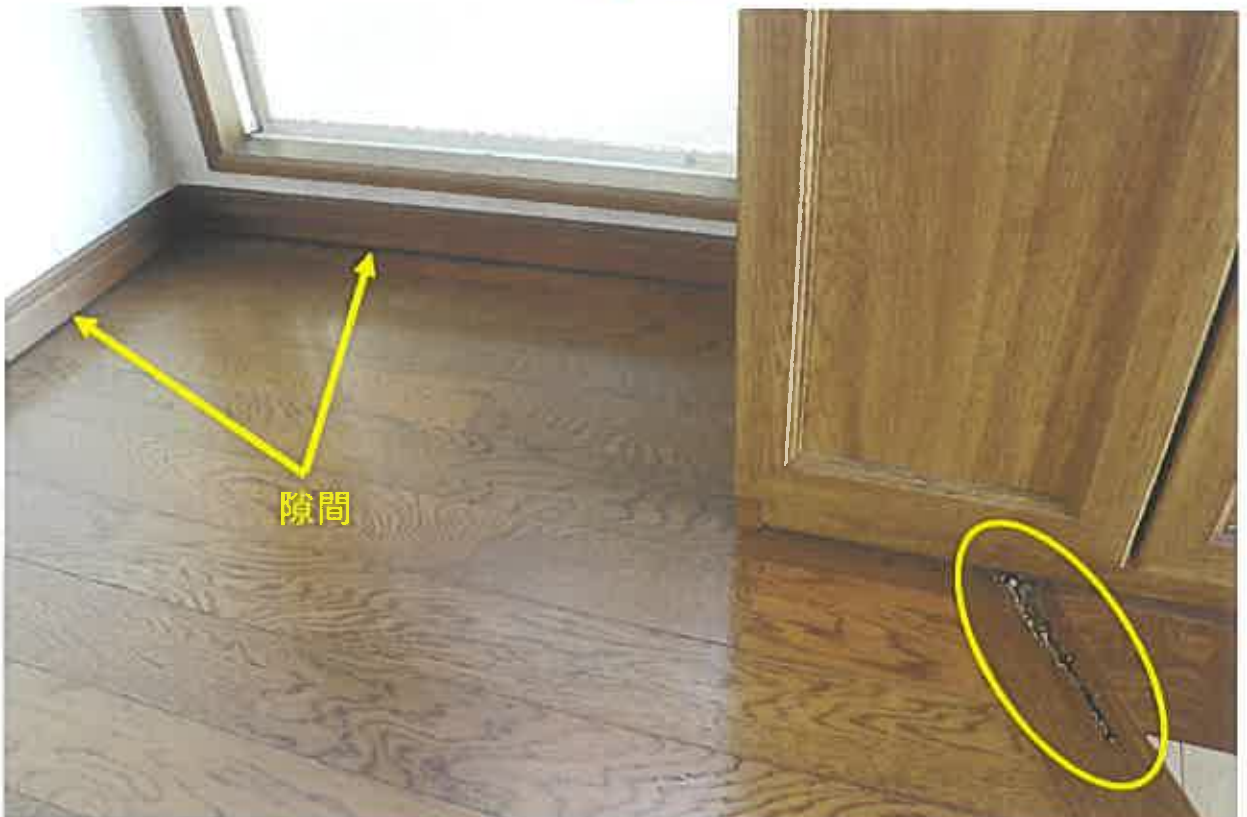
白蟻被害箇所（玄関框・ホール）
