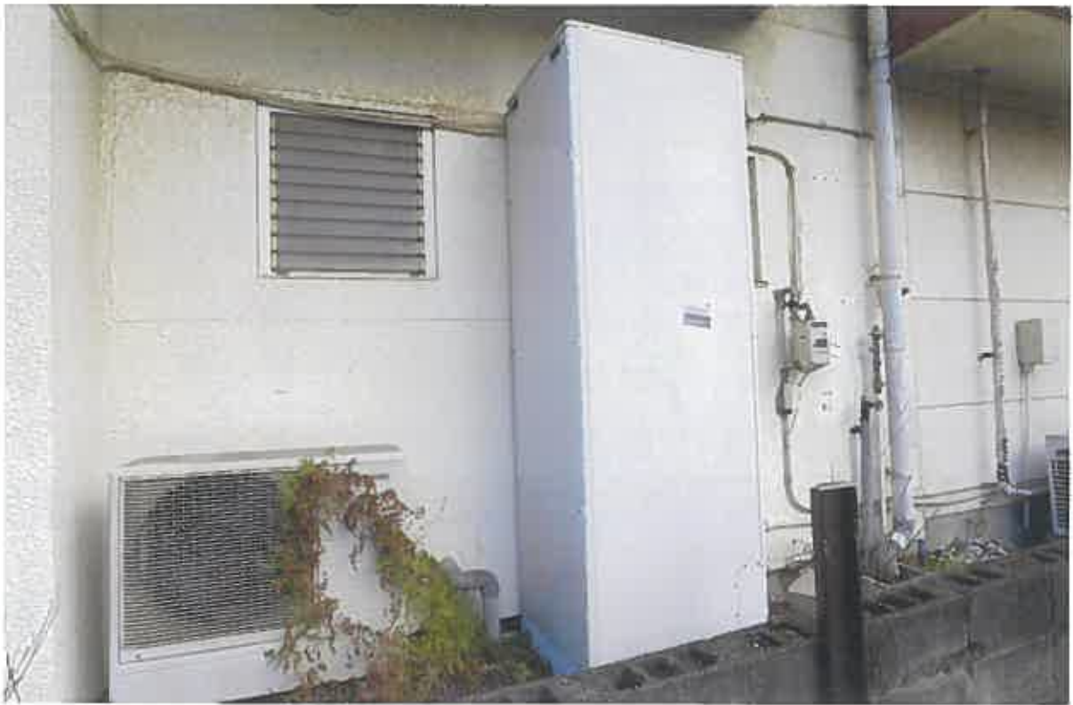
(写真29) 本件建物6の売却対象工作物エコキュート
