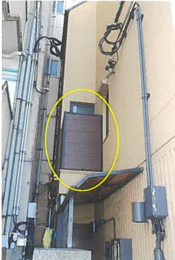
受水槽 (2階屋外)
