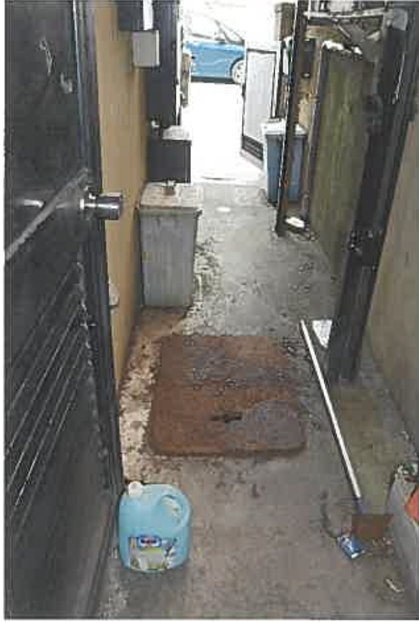
グリストラップ鉄板蓋の腐食 (通用口)
