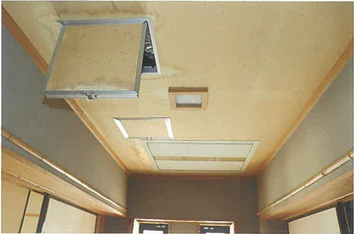
エアコン配管結露によるシミ（2階天井）
