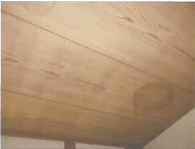
物件 4 天井の雨染み
