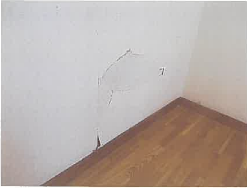
物件 4 内壁の破損
