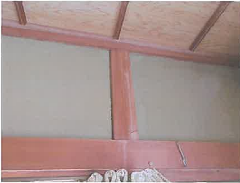
物件 4 内壁の雨染み
