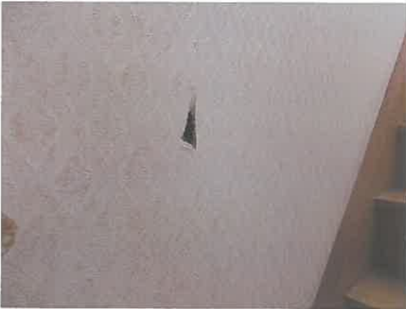
物件 4 内壁の破損
