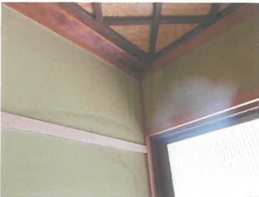
物件 4 内壁の雨染み
