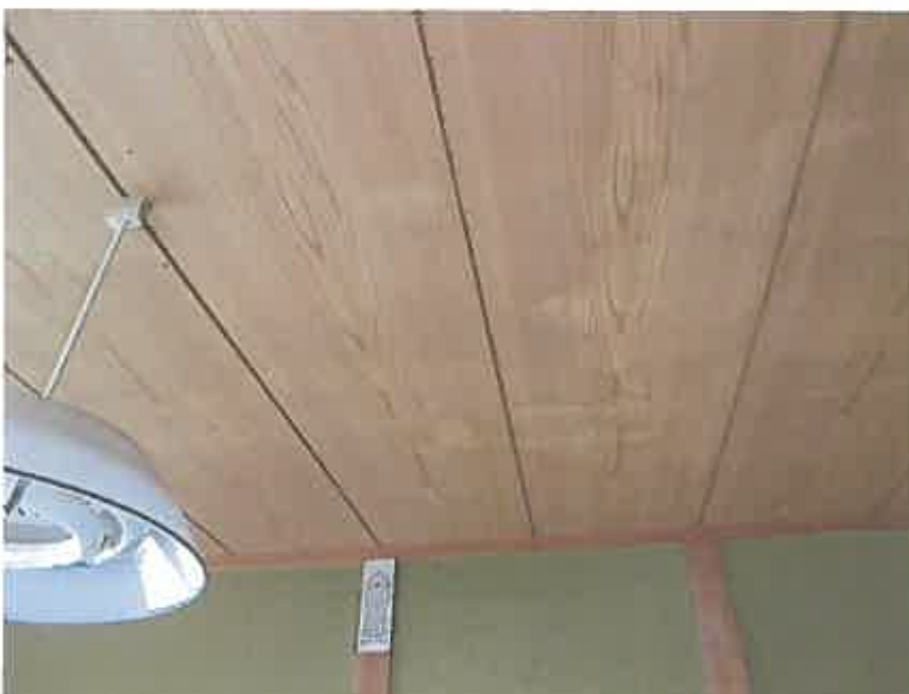
物件 4 天井の雨染み
