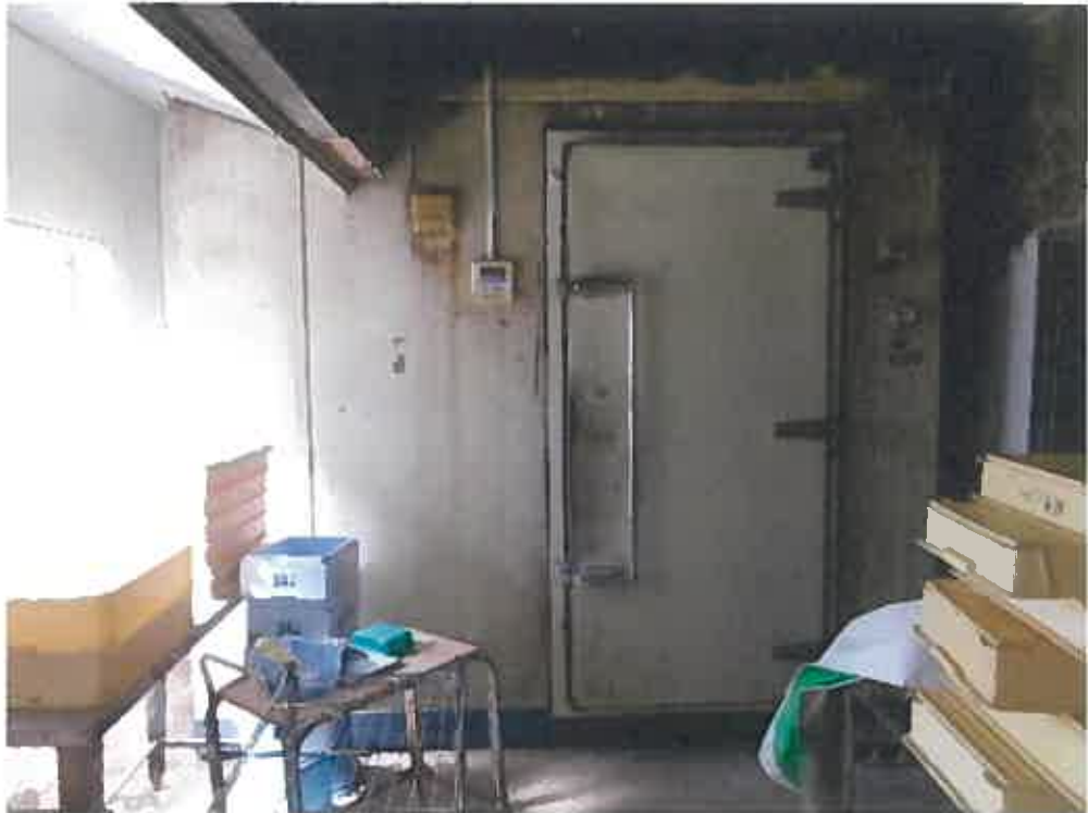
(写真17) 物件2の建物内部のプレハブ冷凍庫
