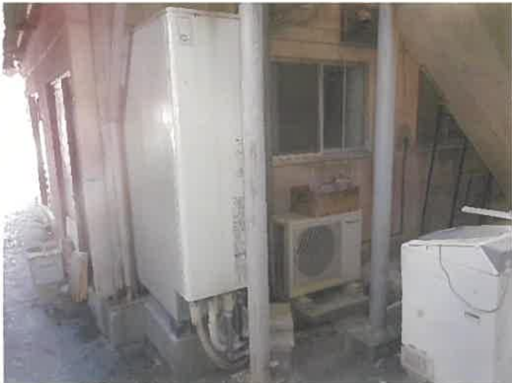
(写真8) エコキュート
