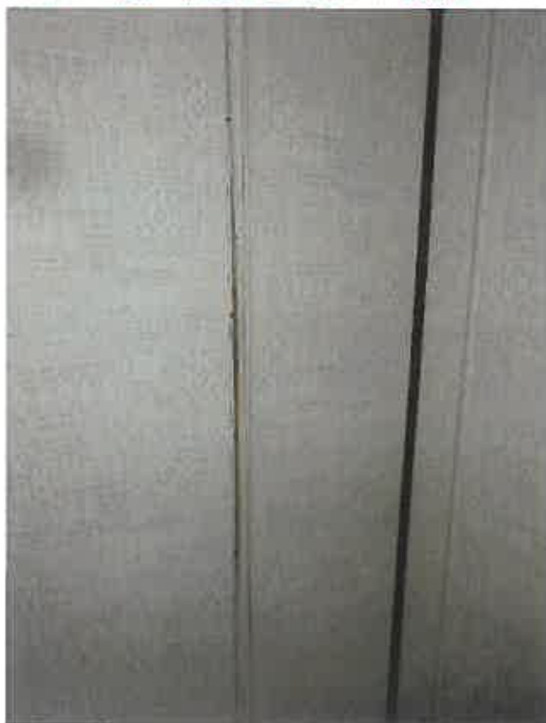
物件3（建物）内部 2階 洋室内壁のクロス剥離
