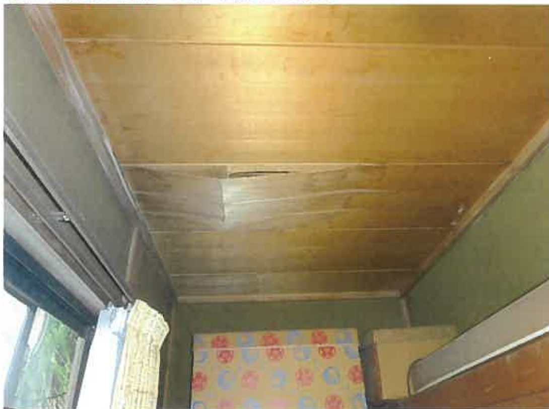
物件3（建物）内部 1階 広縁天井の損傷
