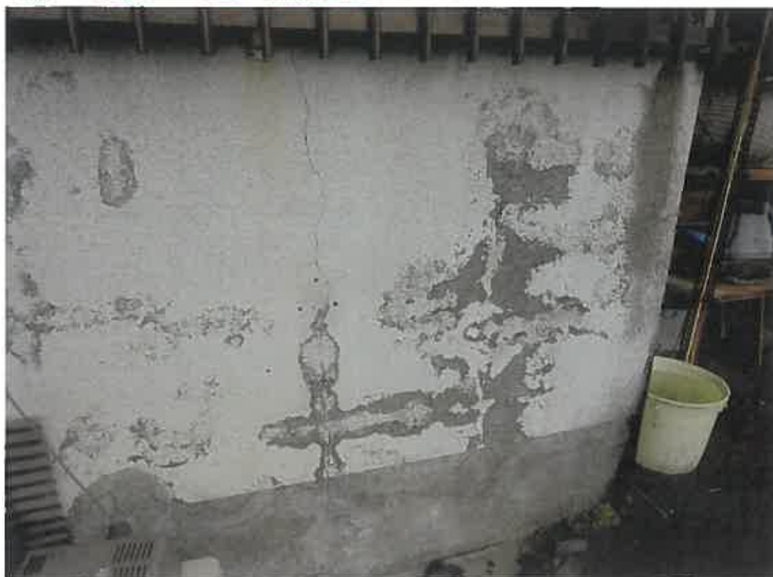
物件3（建物） 外壁の汚損劣化とクラック
