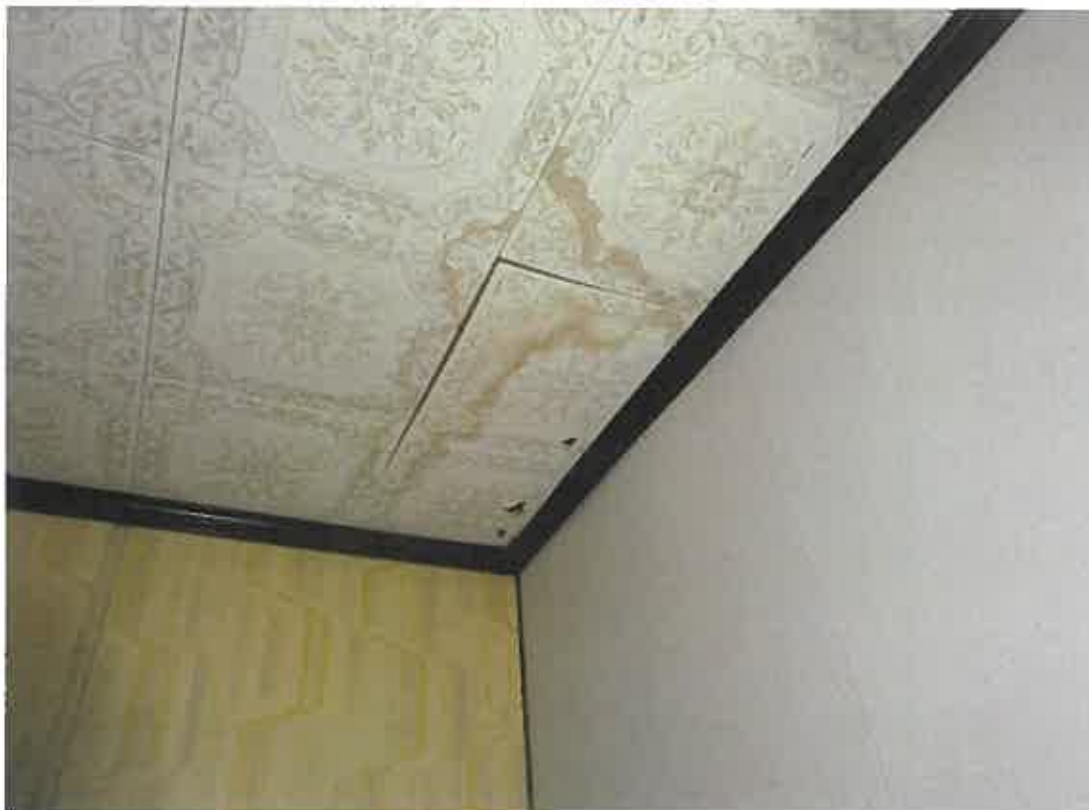
物件3（建物）内部 2階 洋室天井の雨漏り跡
