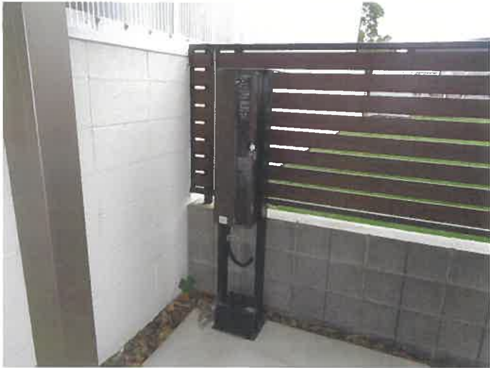
(写真3) 売却対象物件(従物)である充電スタンド
