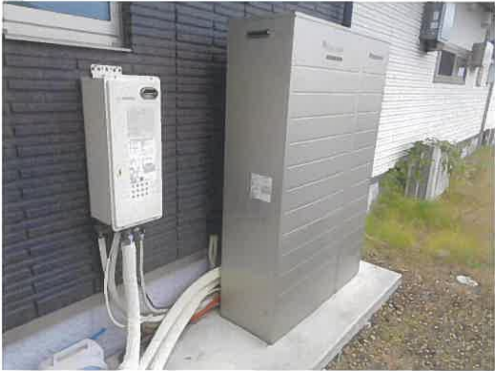
(写真5) 売却対象物件(従物)であるエネファーム
