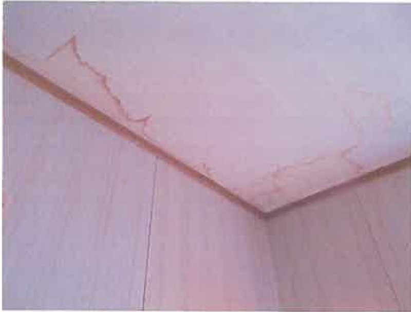
物件 2 天井の雨染み
