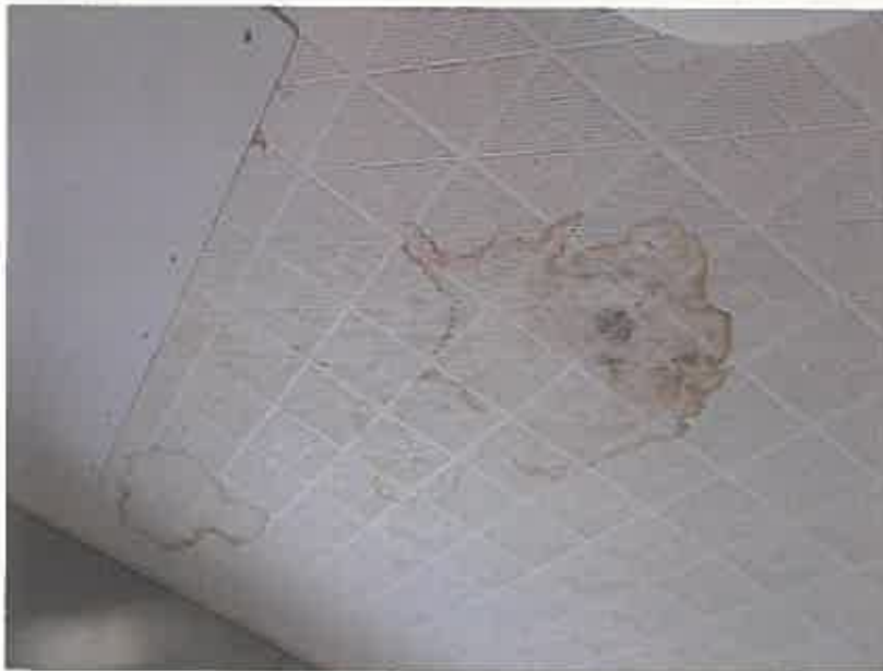
物件 2 天井の雨染み
