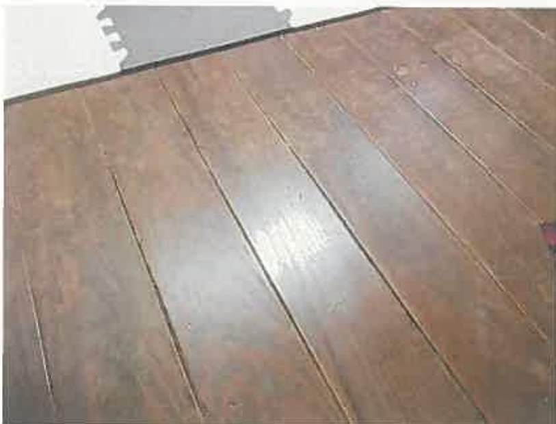
物件 2 床の撓み・沈み
