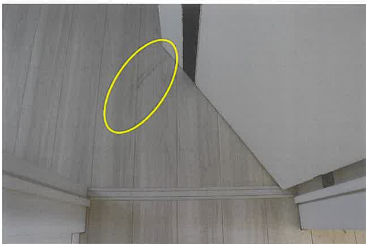
扉の開閉不良（2階：洋室①）
