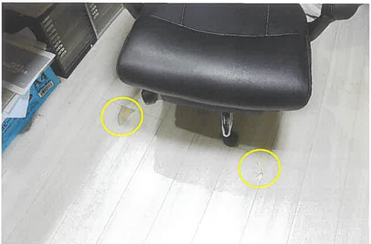
フローリング合板の損傷（1階：洋室）
