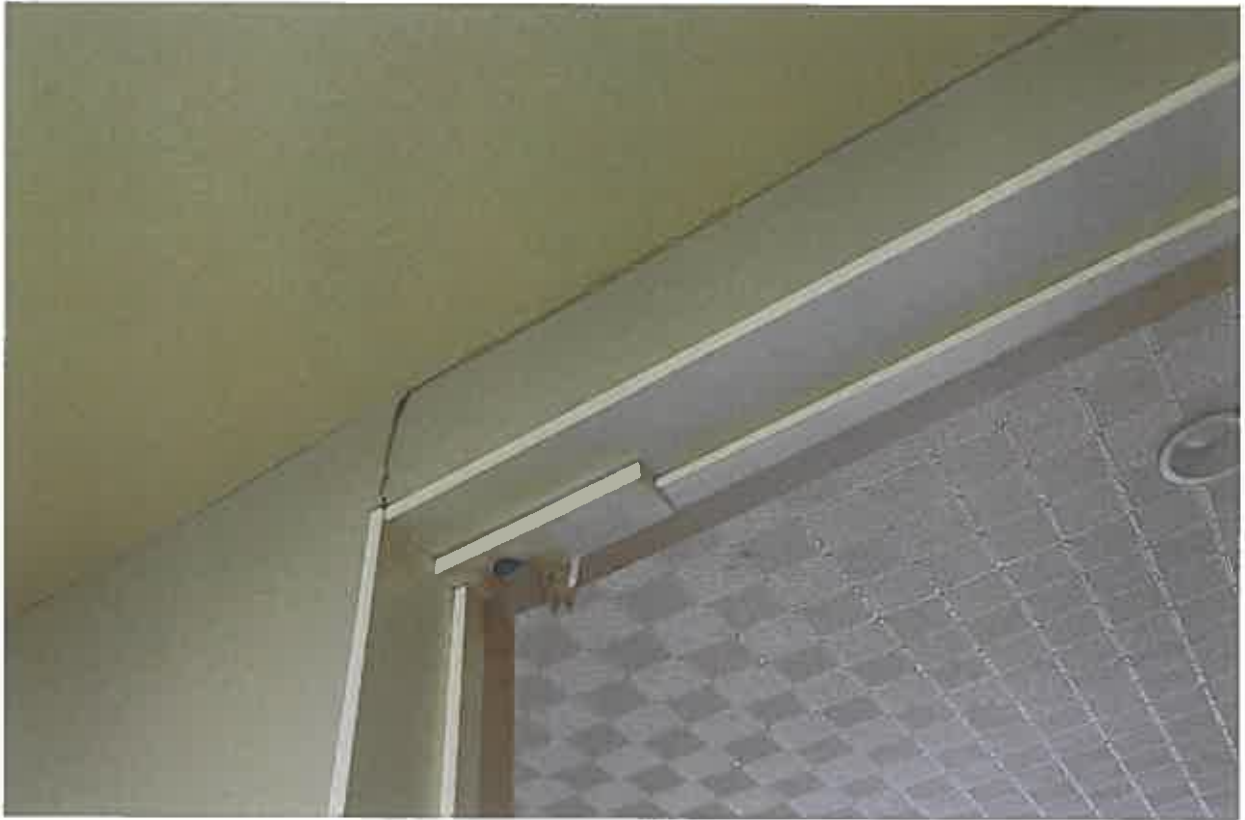
壁クロスの破断（1階：洋室）
