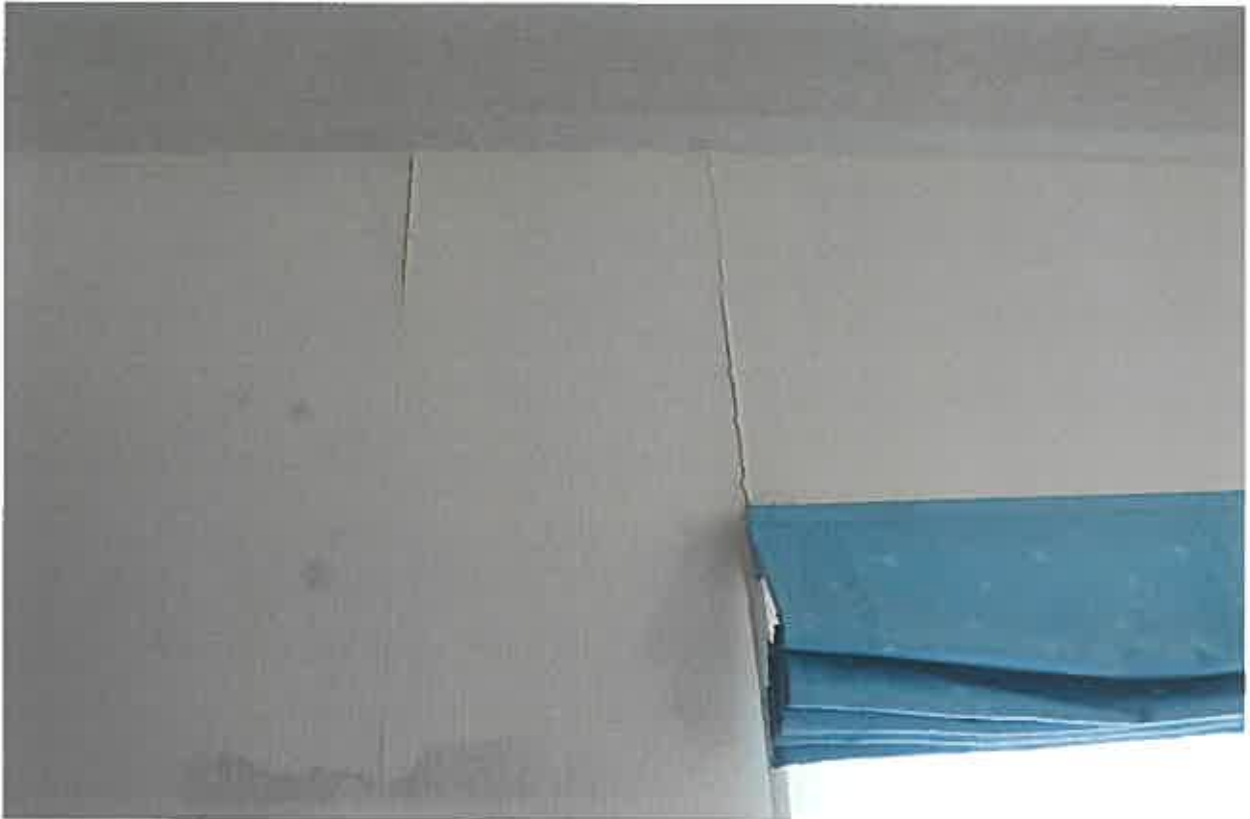
壁クロスの亀裂・汚損（2階；洋室④）
