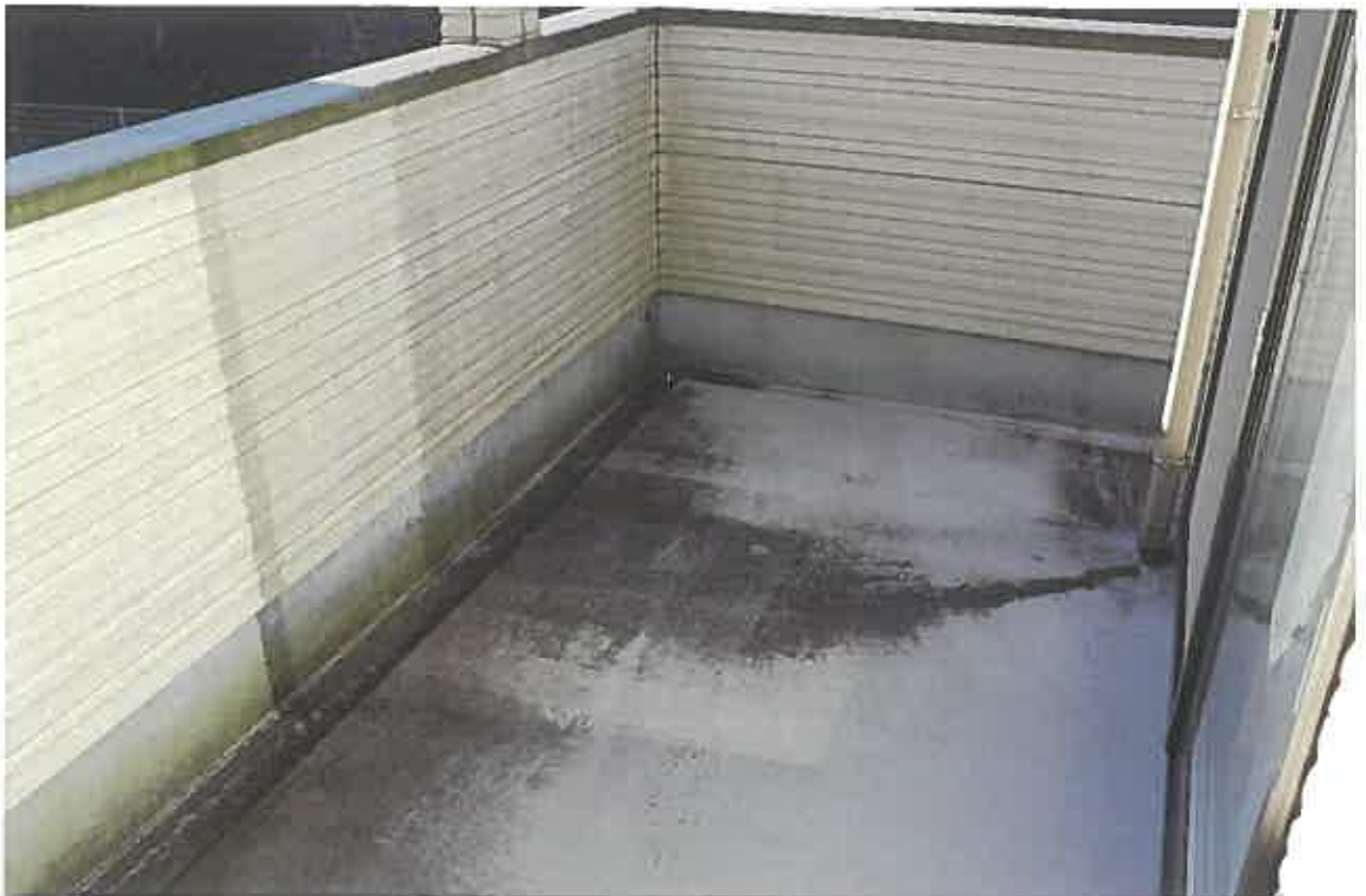
バルコニーの排水不良
