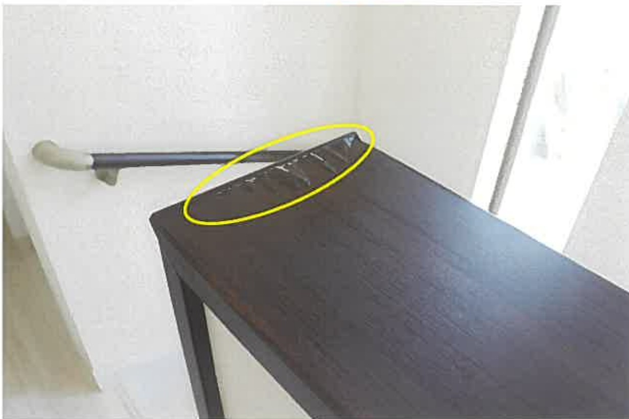
手摺天端の損傷（2階：廊下）
