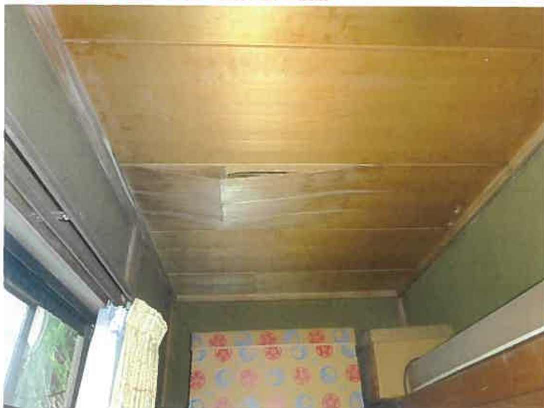
物件3（建物）内部 1階 広縁天井の損傷
