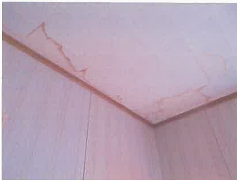
物件 2 天井の雨染み
