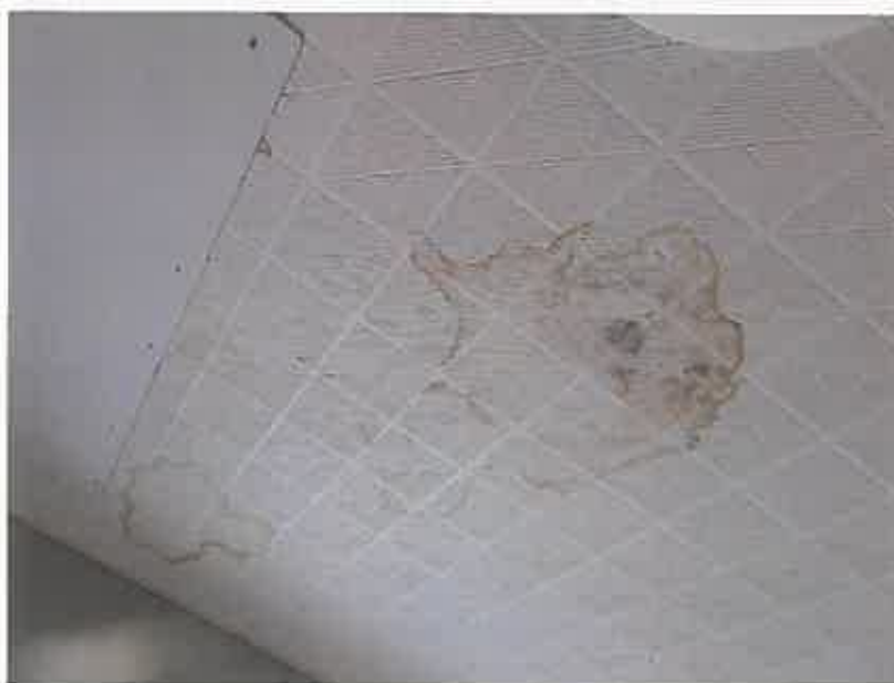
物件 2 天井の雨染み
