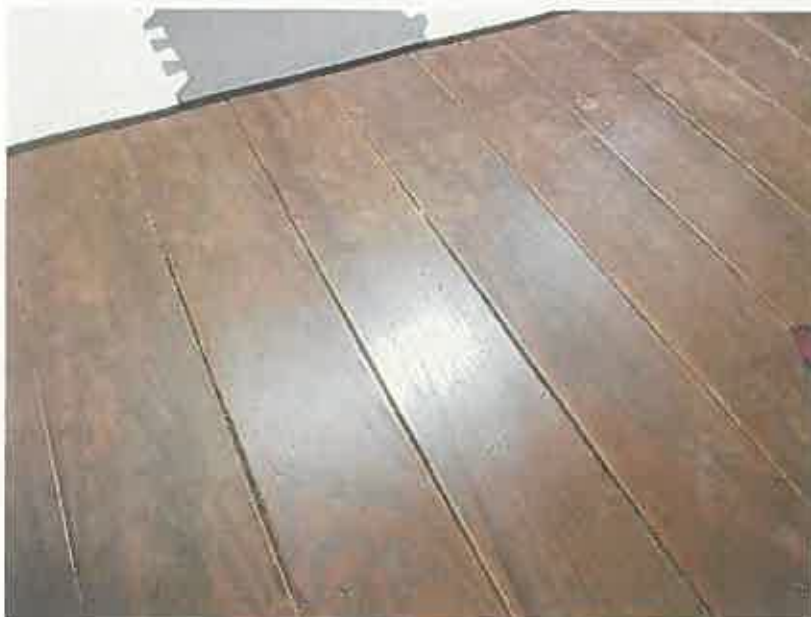
物件 2 床の撓み・沈み
