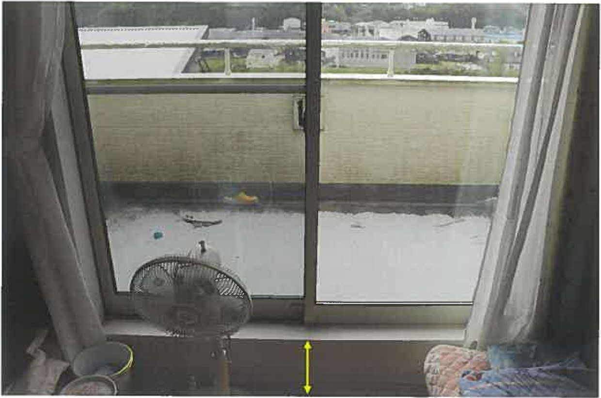
バルコニーとの段差 (2階：洋室①)
