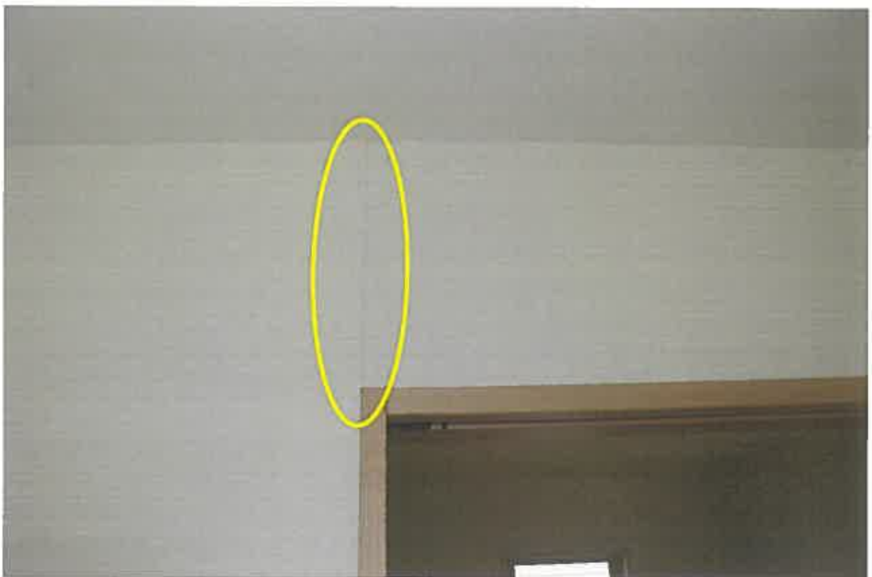
壁クロスの亀裂 (2階：洋室①)
