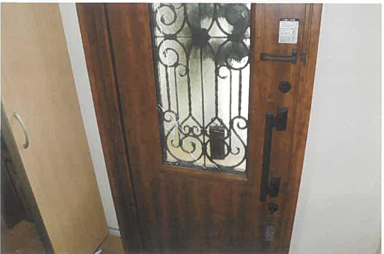
扉のガラス破損（1階；玄関）
