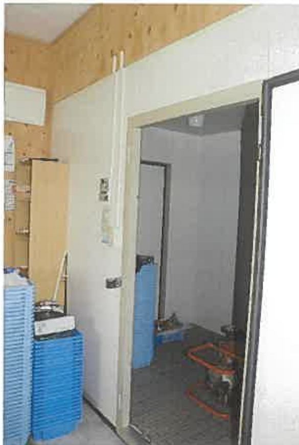
作業場内保冷库
