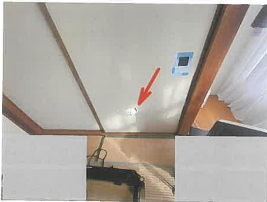
汚損の状況 和室 建具の損傷
