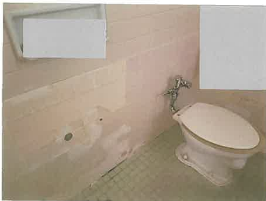
汚損の状況 浴室・便所 タイルの剥がれ・補修箇所
