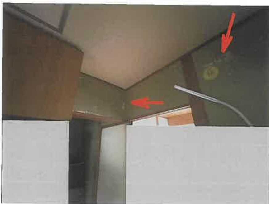
汚損の状況 台所 内壁の剥がれ
