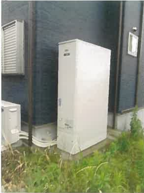
(写真4) 本件建物に備え付けられているヒートポンプ給湯器
