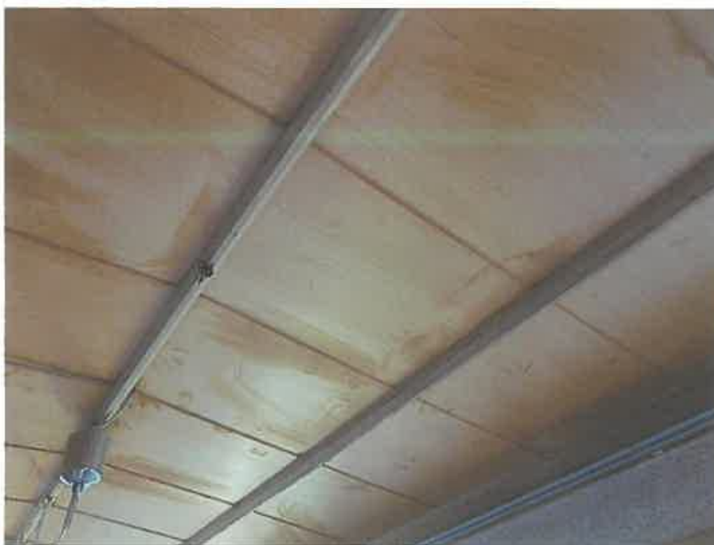
物件2 天井の劣化
