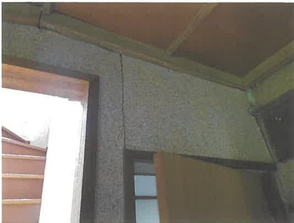
物件2 内壁のクラック
