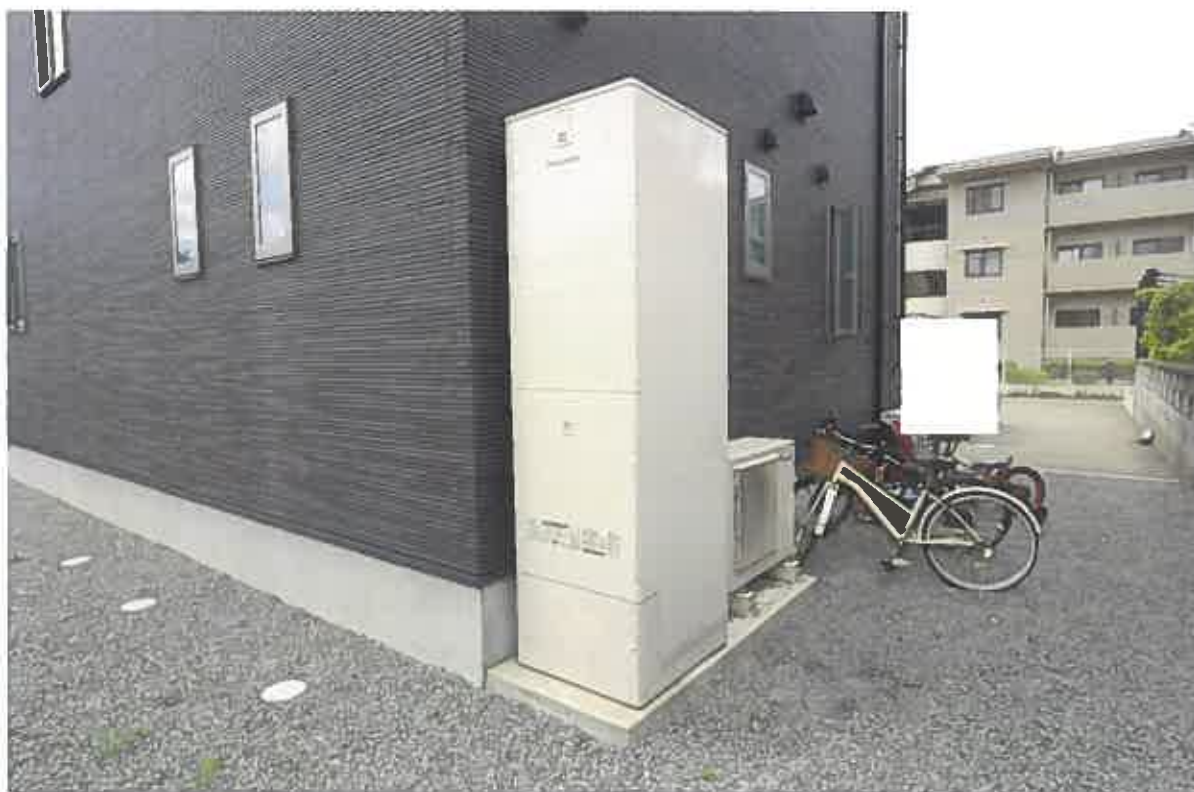
(写真②) 売却対象工作物ヒートポンプ給湯機
