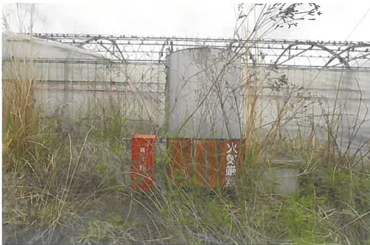
(写真④) 売却対象外②ボイラー
