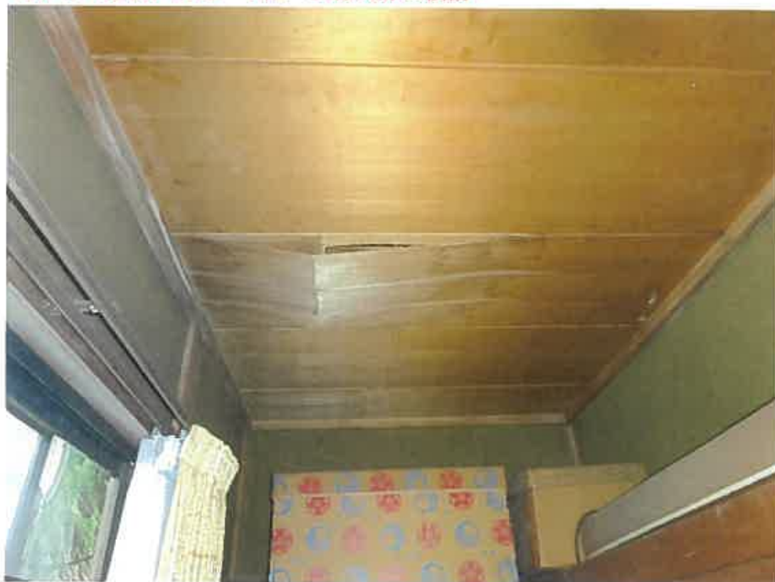
物件3（建物）内部 1階 広縁天井の損傷
