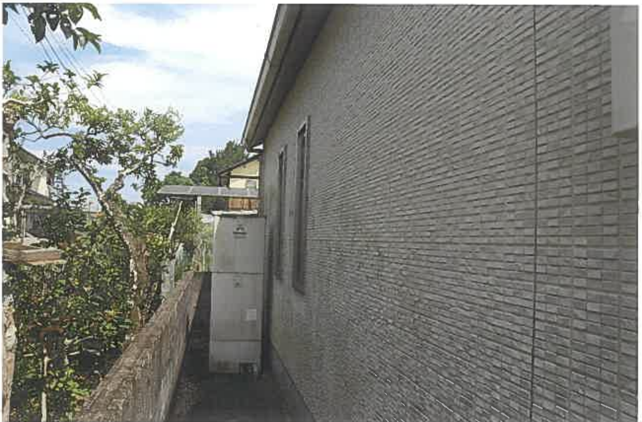
北側外壁の汚損
