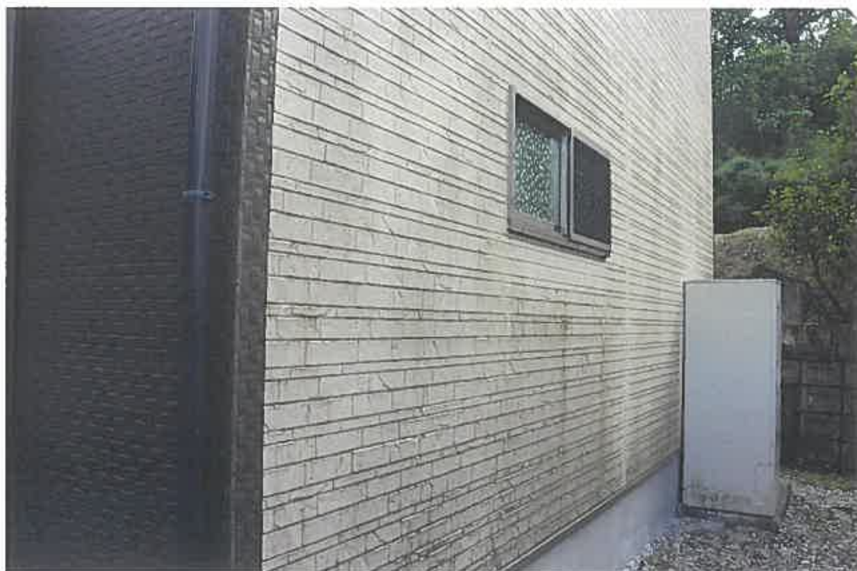
北側外壁の汚損
