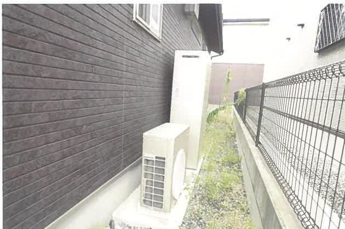
(写真②) 売却対象工作物ガス給湯器, ハイブリッド給湯システムヒートポンプユニット
