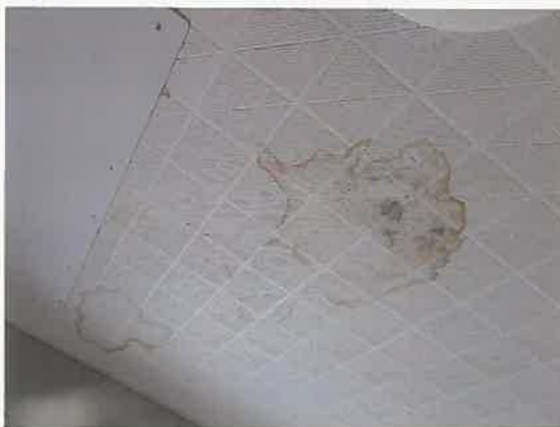
物件 2 天井の雨染み
