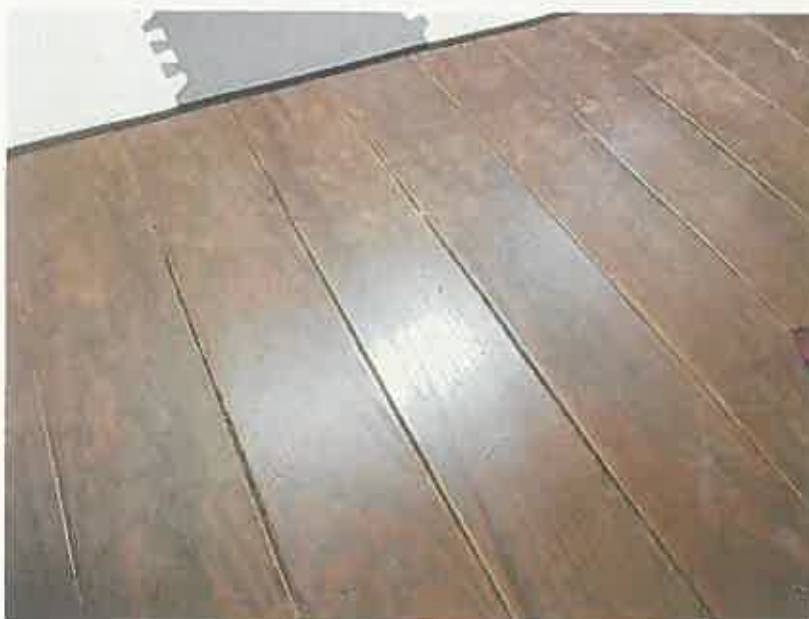
物件 2 床の撓み・沈み
