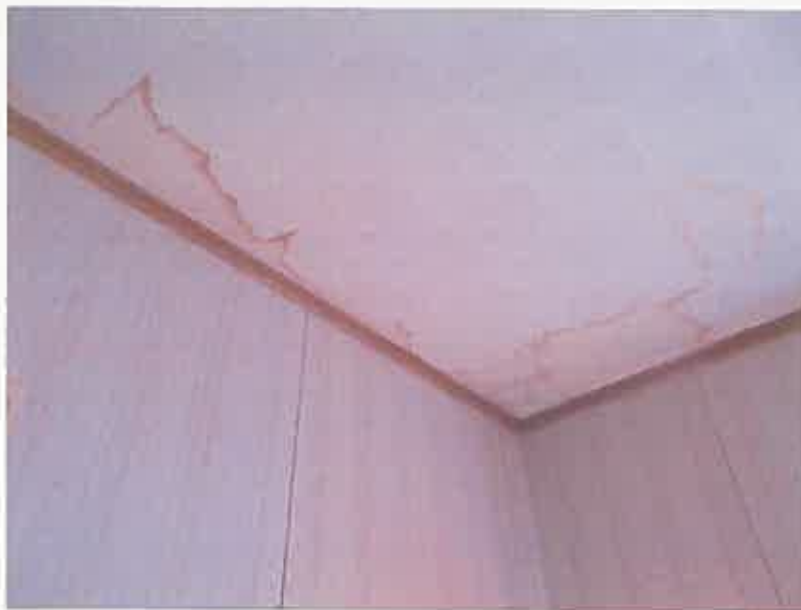
物件 2 天井の雨染み
