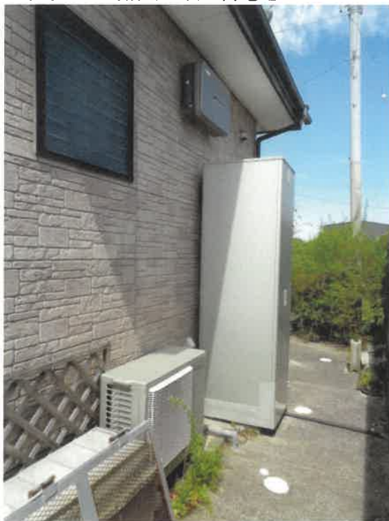
(写真3) ヒートポンプ式給湯器及び蓄電池
