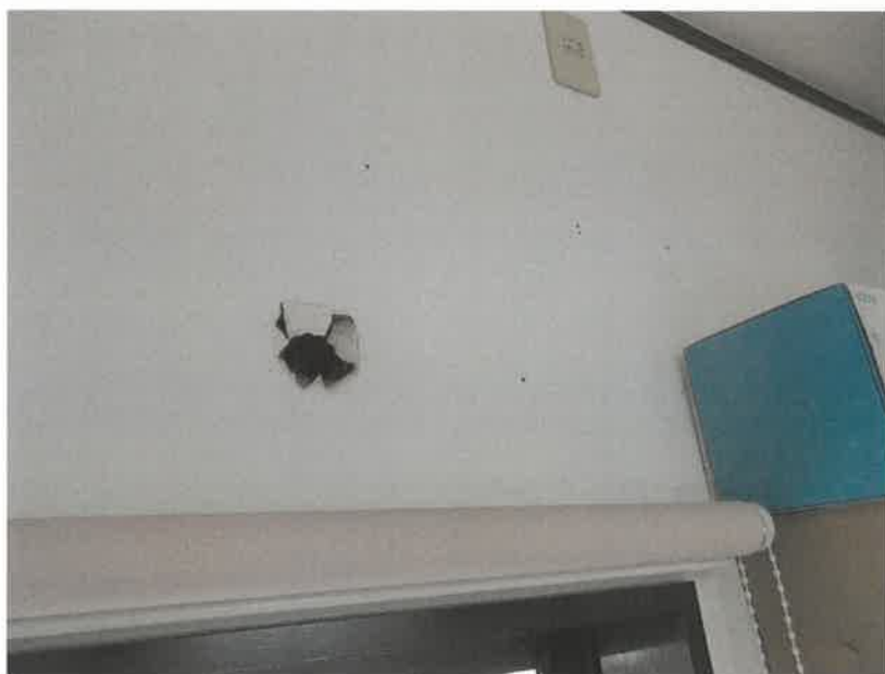
物件 8 2F 洋室(壁の破損)
