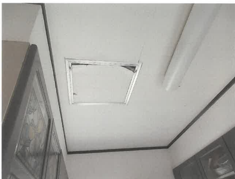
物件 8 キッチン (天井の雨漏り)
