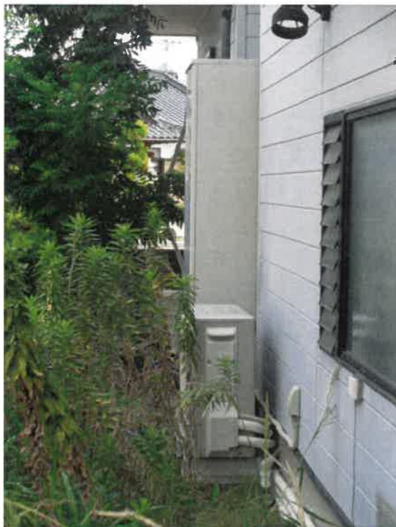
(写真 1 1) 売却対象物件 (従物) であるヒートポンプ式給湯器
