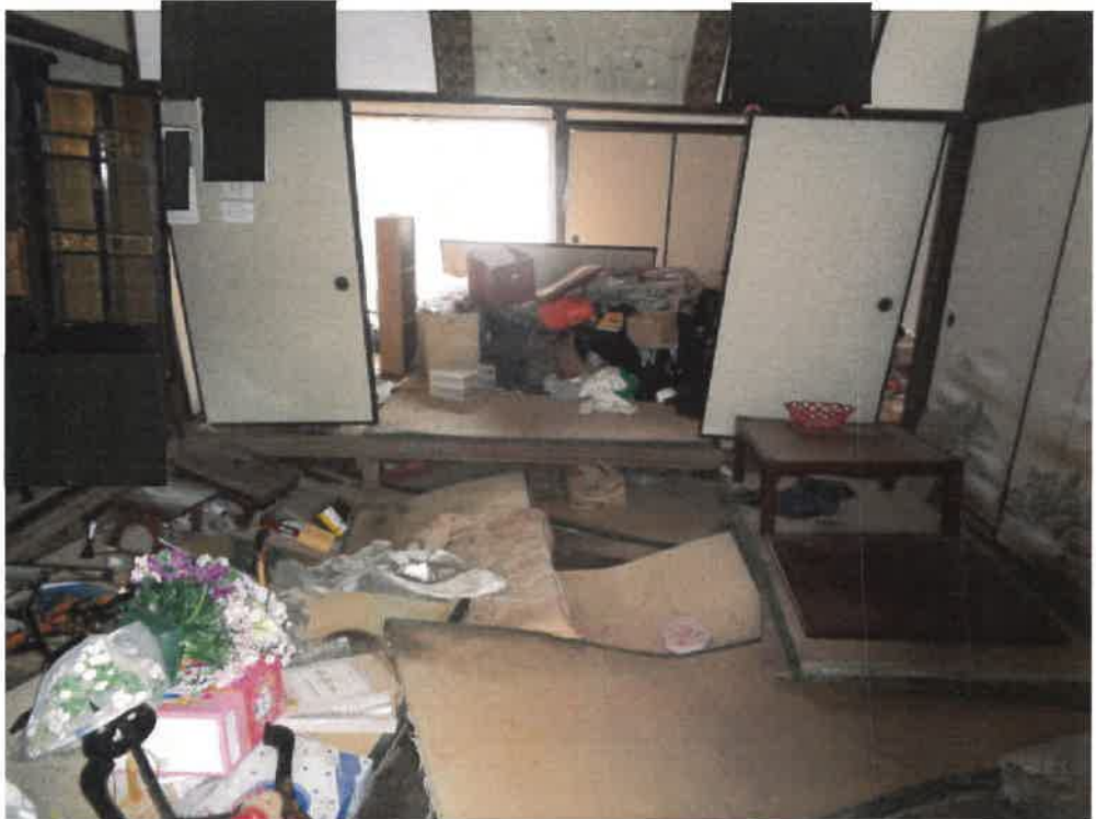
(写真7) 主たる建物内部（1階：床が抜けている）
