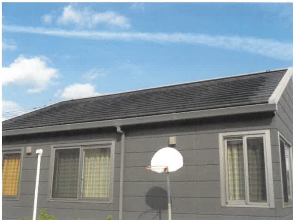
(写真2) 本件建物に備え付けられている太陽光発電パネル
