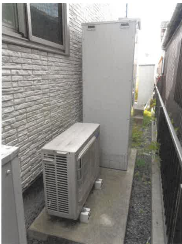
(写真3) 売却対象物件であるヒートポンプ式給湯機
