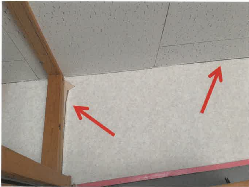
物件 2 内壁の剥がれ、天井の隙間
