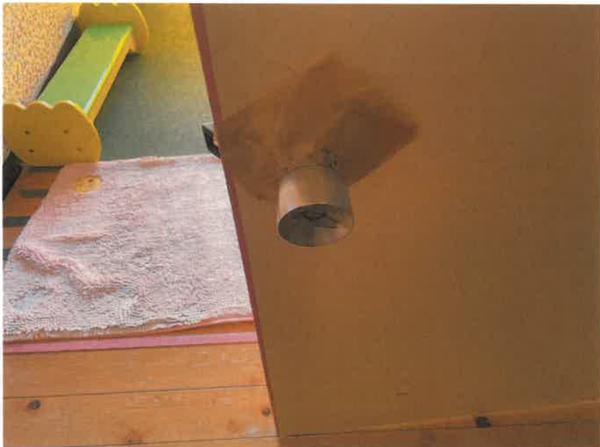
物件 2 建具の損傷
