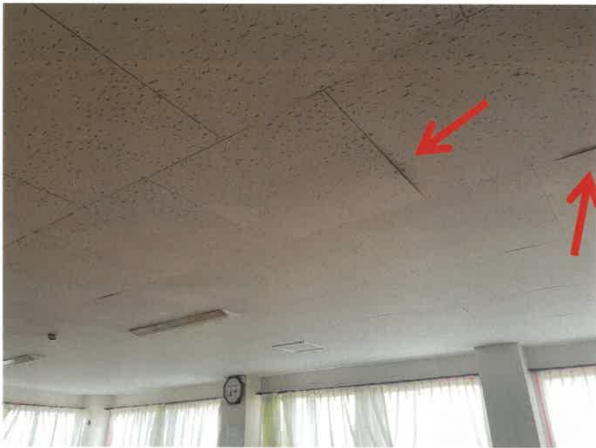
物件 2 天井の弛み、隙間
