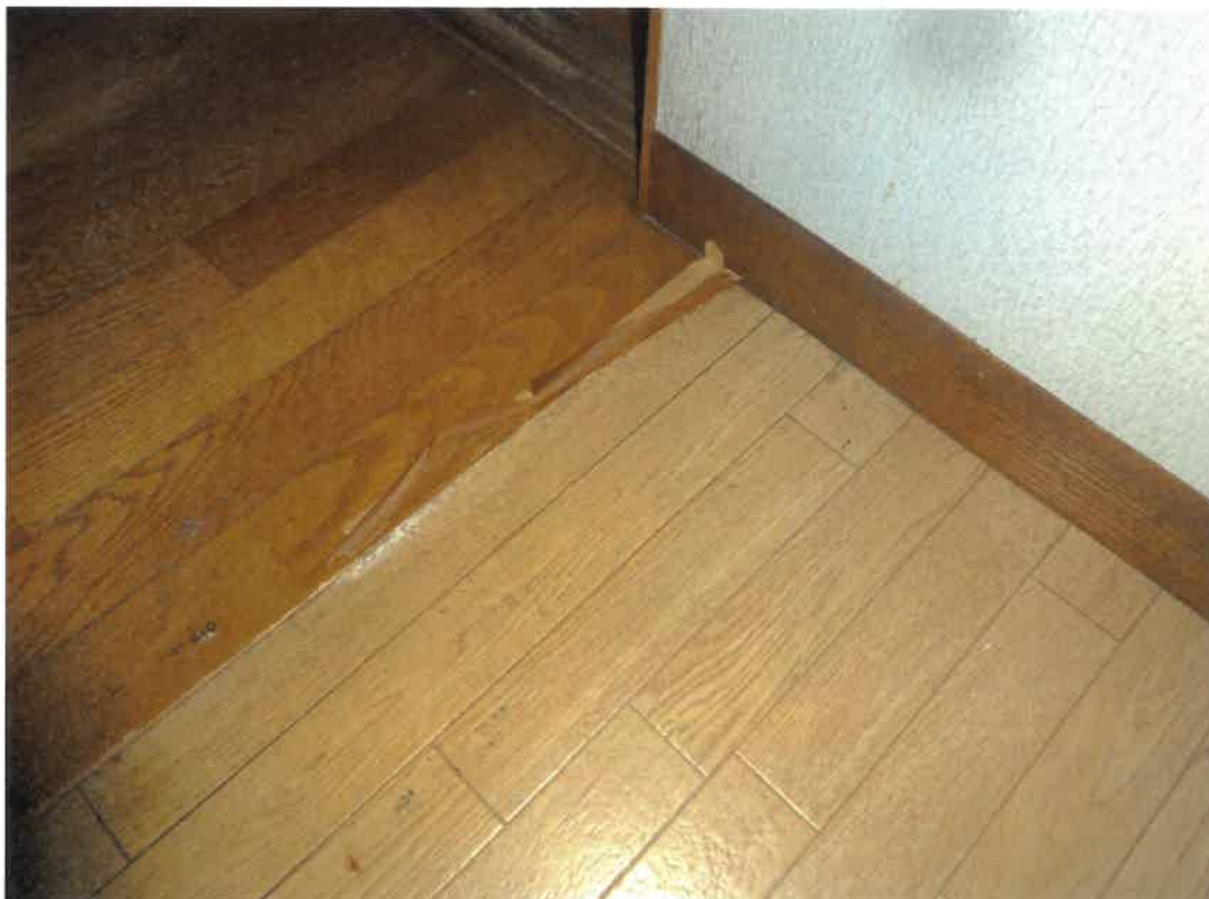
物件7（主である建物）内部 床の劣化箇所
