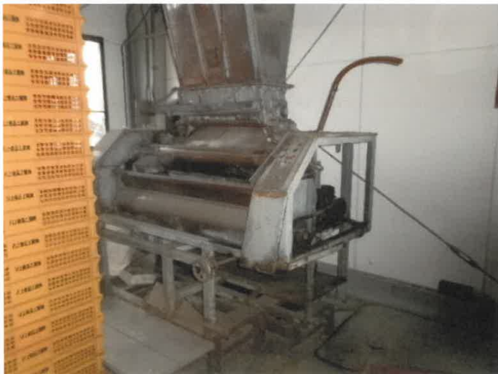
(写真 2 1) 物件 5 の建物内部の機械器具類 (2 階) (ミキサー)
