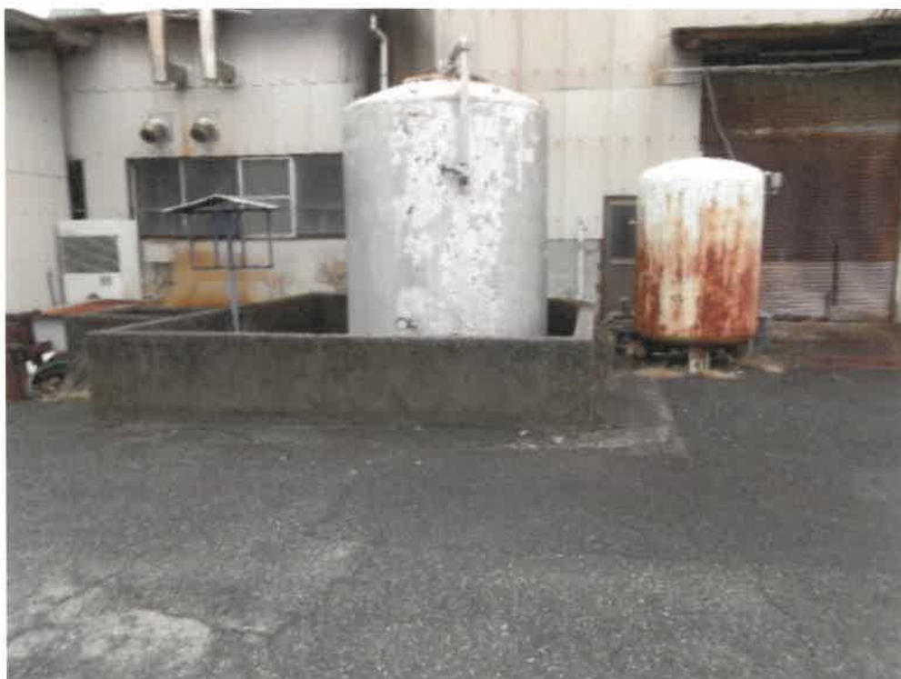
(写真2) 売却対象物件（物件5の建物の従物）である重油タンク
