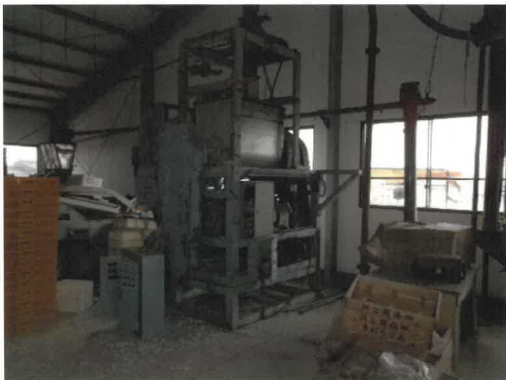
(写真19) 物件5の建物内部の機械器具類(2階)(ミキサー)
