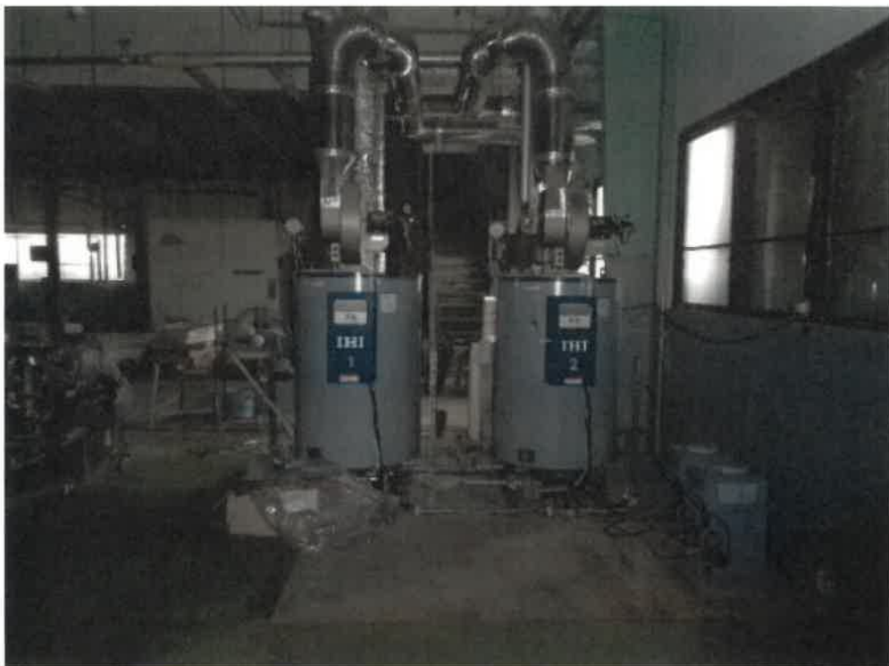
(写真 1 6) 物件 5 の建物内部の機械器具類 (1 階) (ボイラー)
