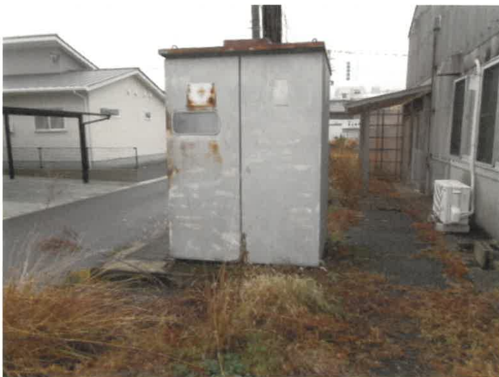
(写真 5) 売却対象物件 (物件 5 の建物の従物) である変電設備
