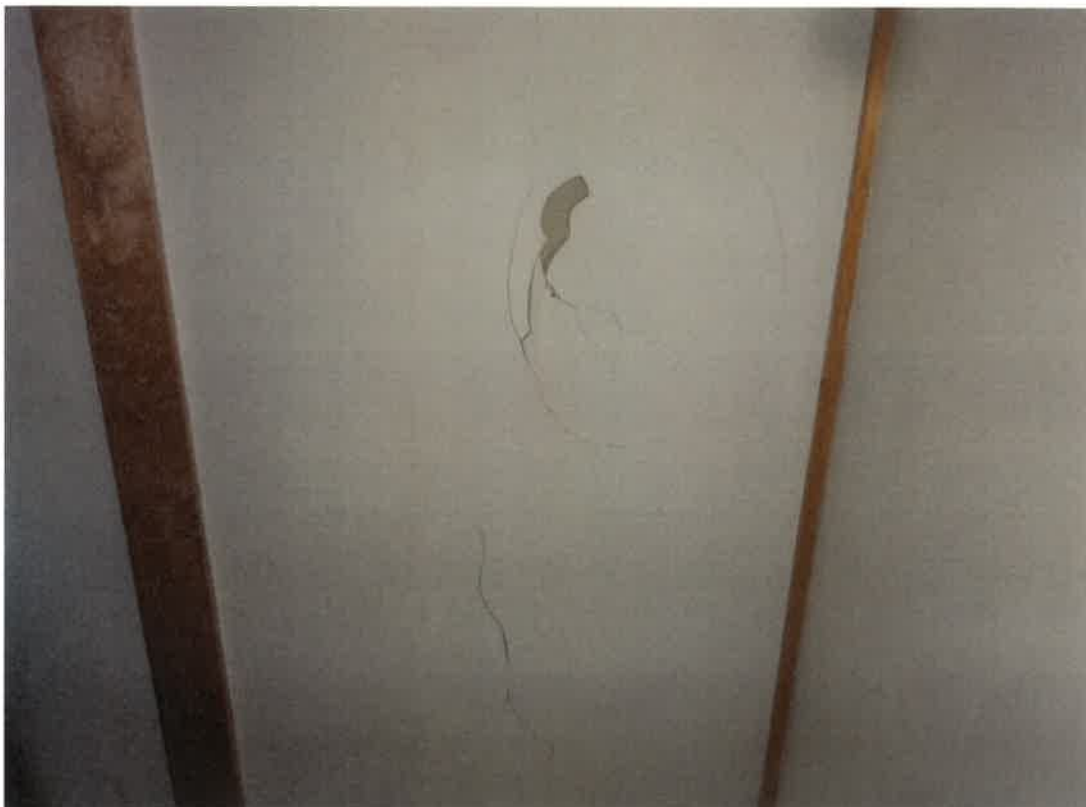
物件7（主である建物）内部 内壁の損傷箇所
