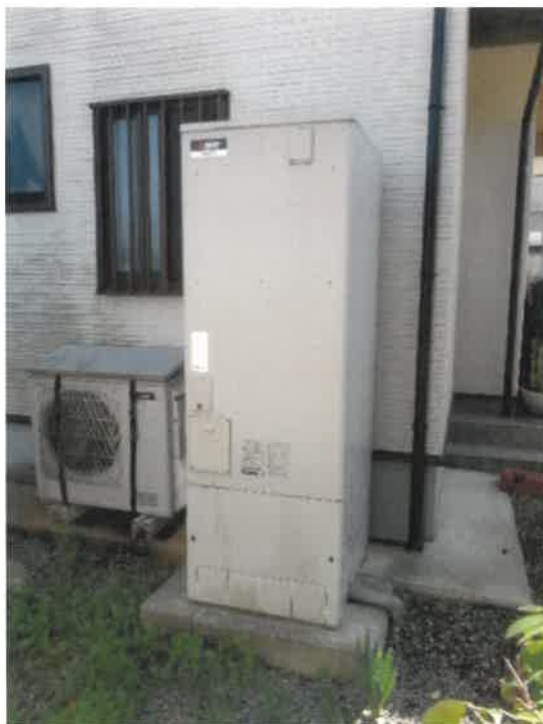
(写真7) 売却対象物件（物件4の建物の従物）であるエコキュート
