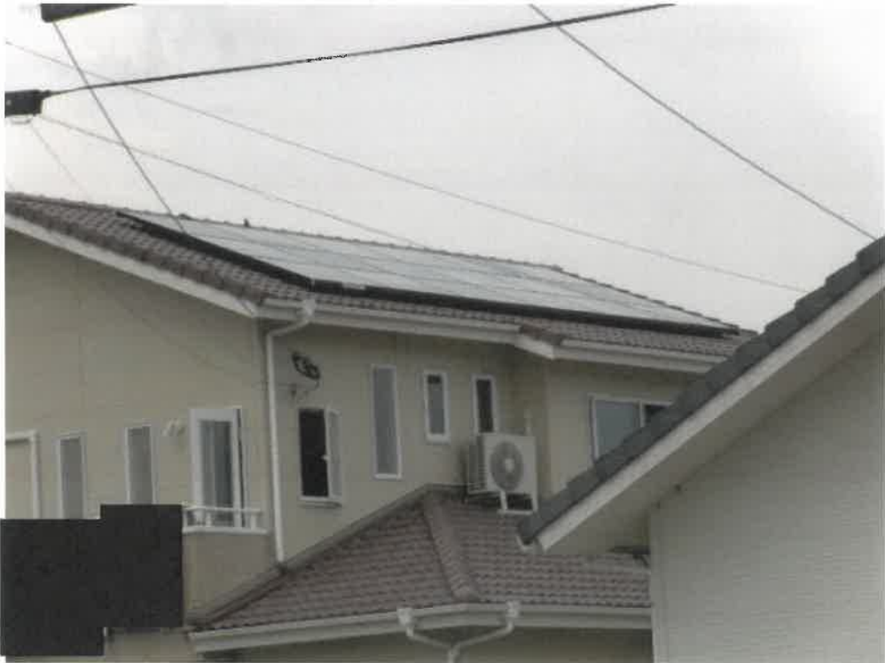
(写真4) 売却対象物件である太陽光発電システム
