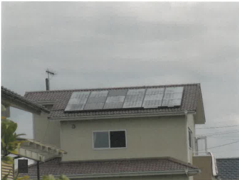
(写真5) 売却対象物件である太陽光発電システム
