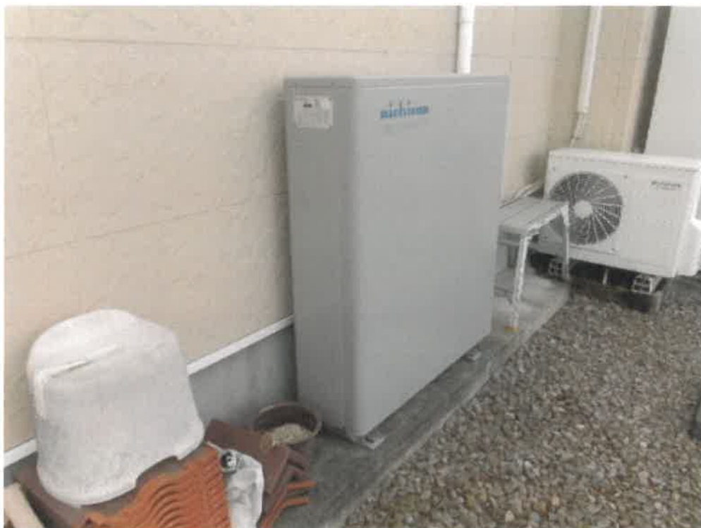
(写真7) 売却対象外物件である蓄電池
