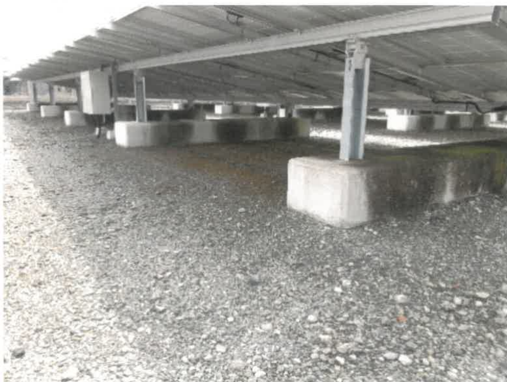
(写真 1 5) 工場抵当法 3 条の機械器具等 (架台)
