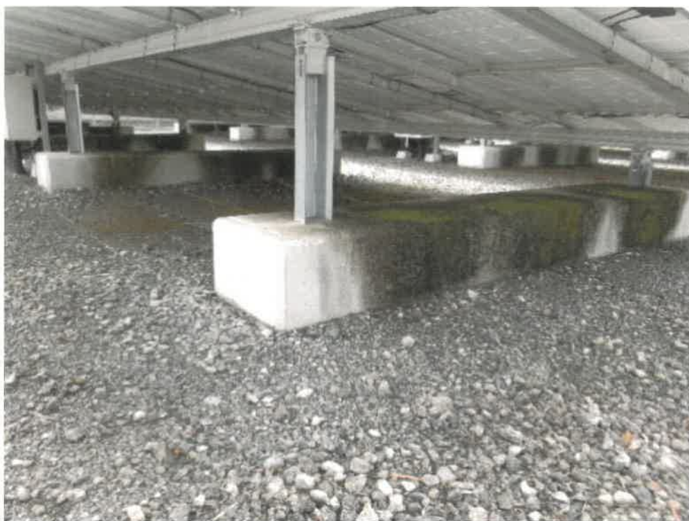
(写真 16) 工場抵当法 3 条の機械器具等 (架台)
