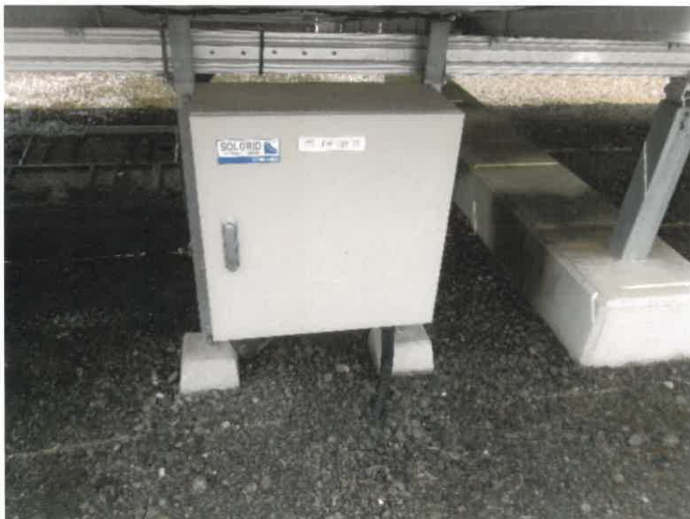
(写真11) 工場抵当法3条の機械器具等(パワーコンディショナ)
