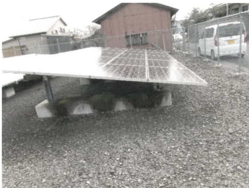
(写真6) 工場抵当法3条の機械器具等(太陽電池モジュール20枚)
