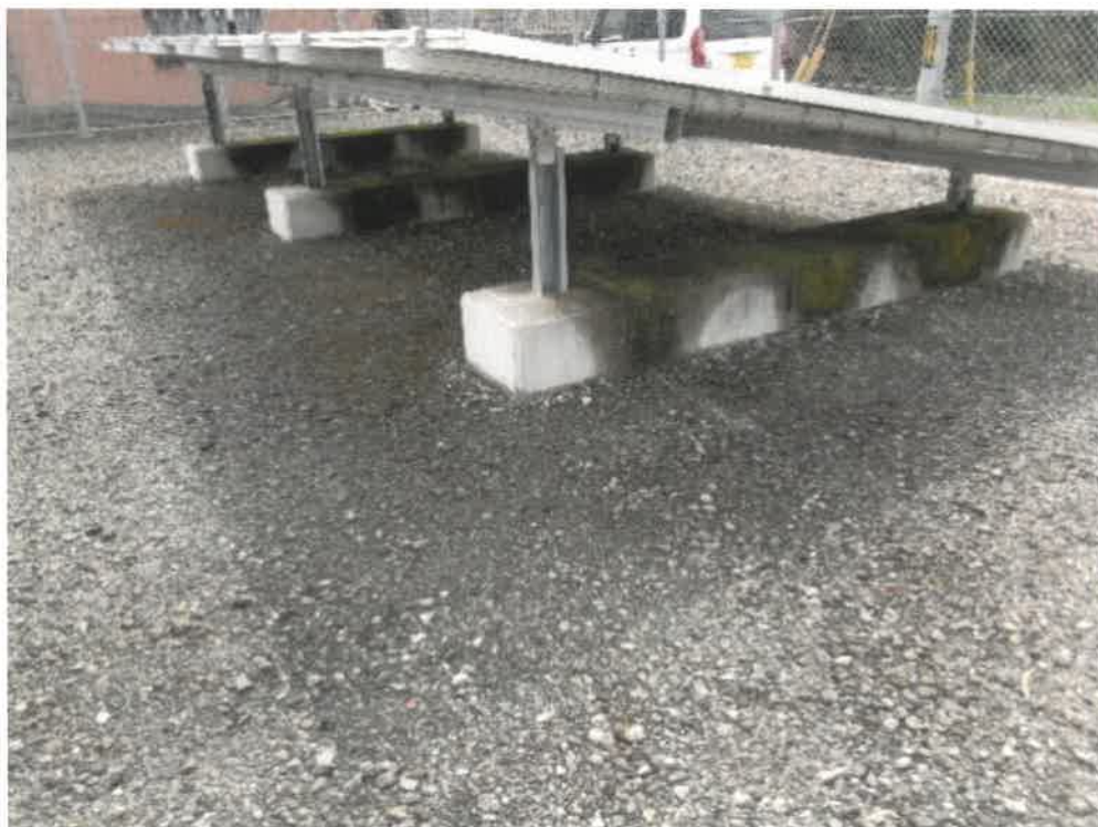
(写真 1 3) 工場抵当法 3 条の機械器具等 (架台)
