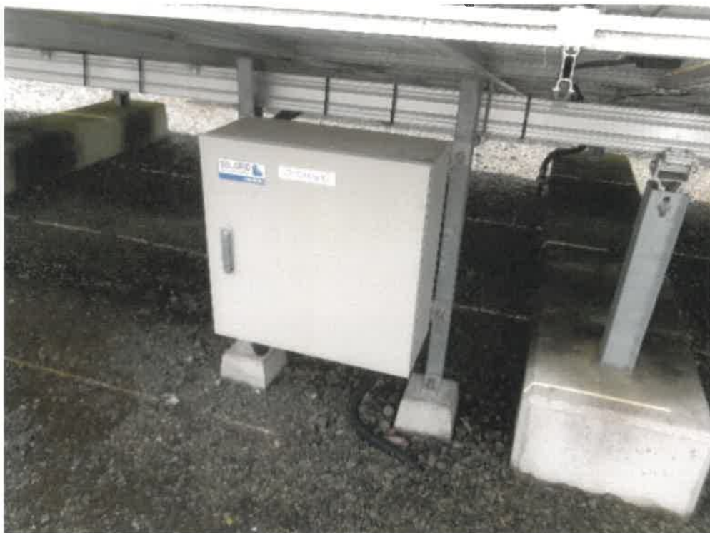
(写真10) 工場抵当法3条の機械器具等(パワーコンディショナ)
