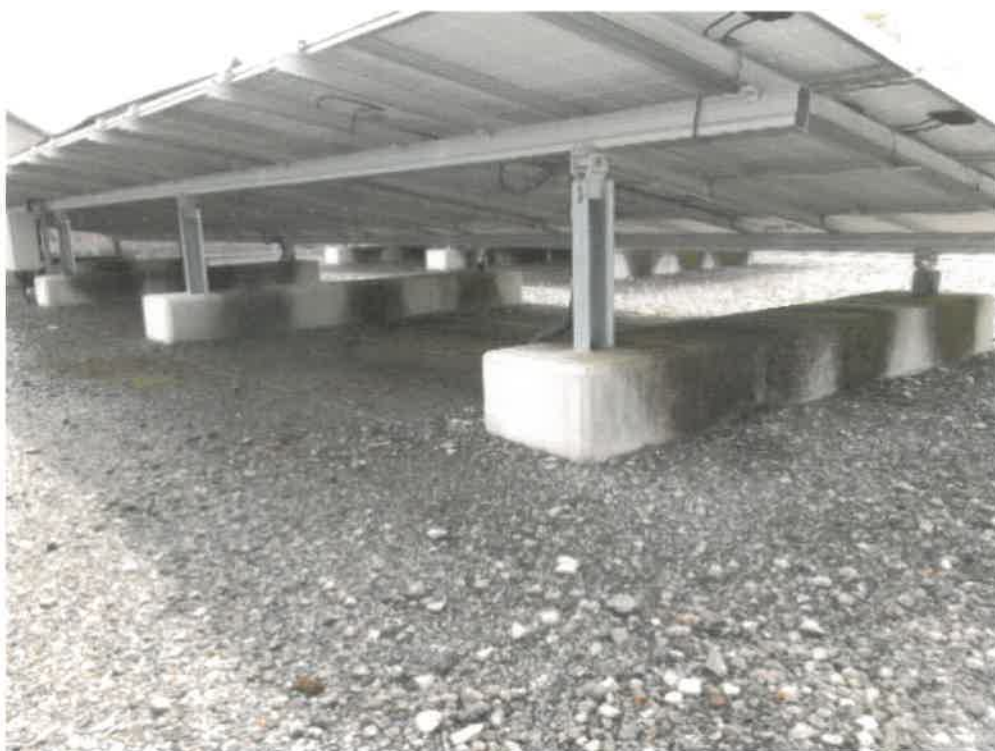
(写真 1 4) 工場抵当法 3 条の機械器具等 (架台)
