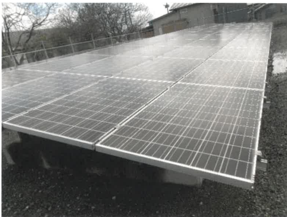
(写真 8) 工場抵当法 3 条の機械器具等 (太陽電池モジュール 40 枚)
