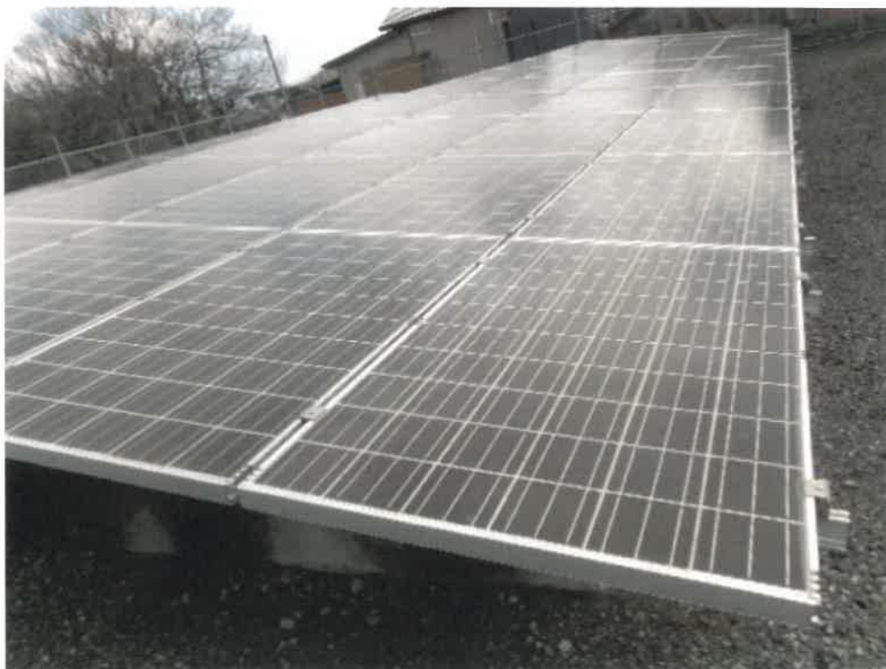
(写真7) 工場抵当法3条の機械器具等(太陽電池モジュール40枚)
