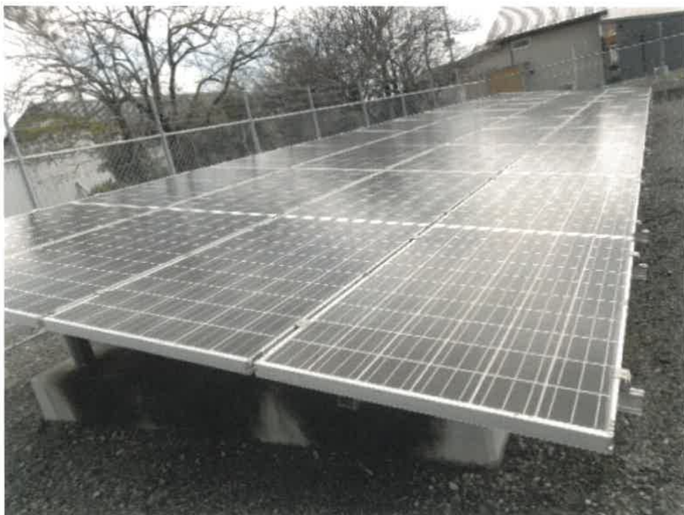
(写真 9) 工場抵当法 3 条の機械器具等 (太陽電池モジュール 40 枚)
