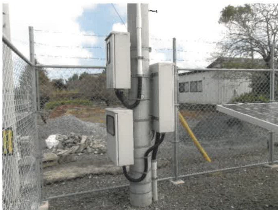
(写真 1 8) 工場抵当法 3 条の機械器具等の従物である引込計器箱, D/T 監視盤及び引込電源盤
