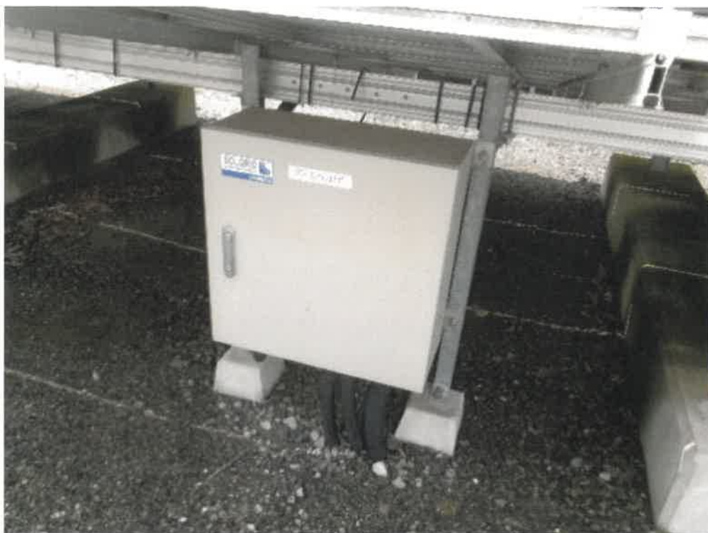
(写真 1 2) 工場抵当法 3 条の機械器具等 (パワーコンディショナ)
