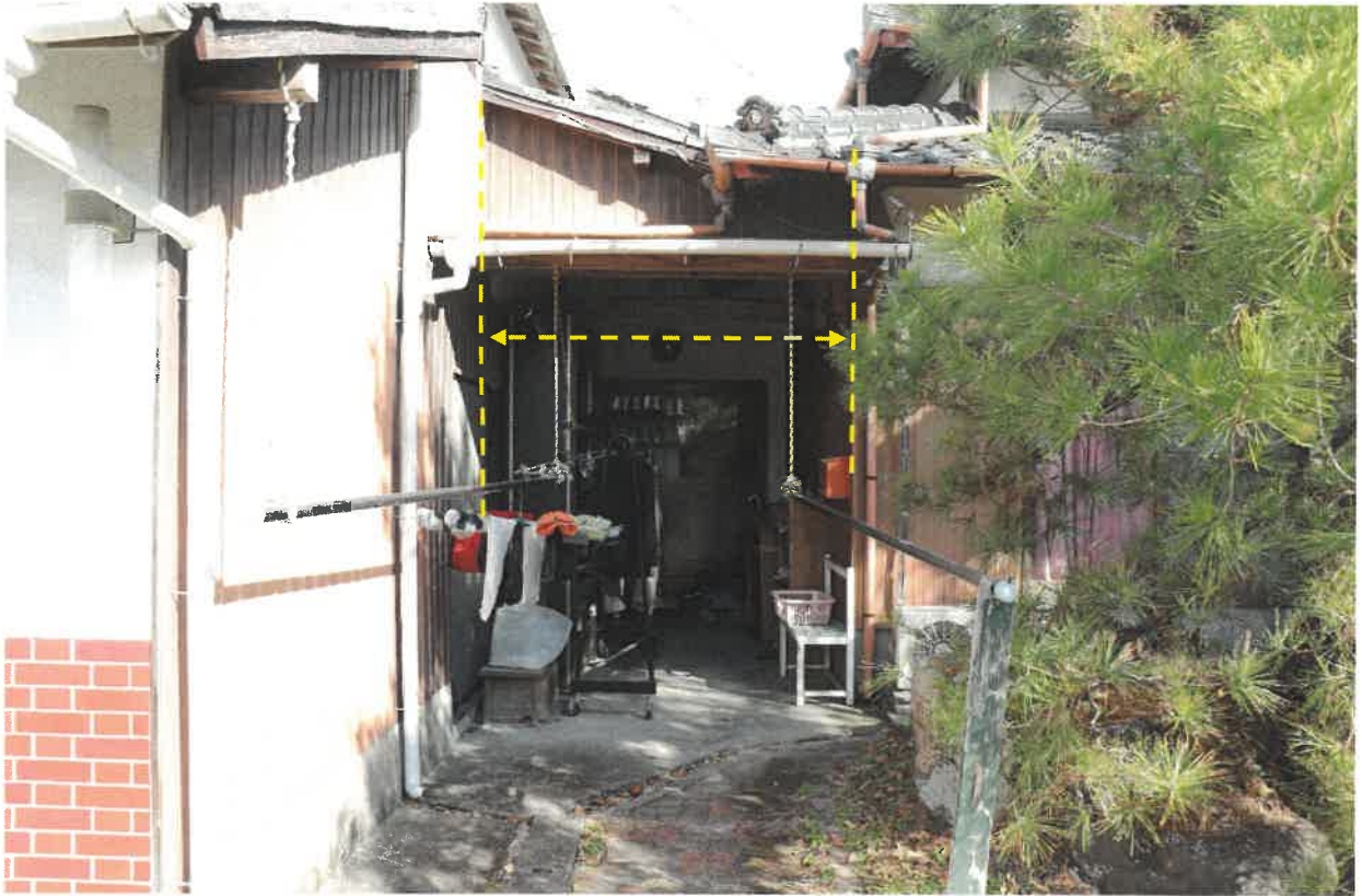
物件3との結合部分（未登記増築）
