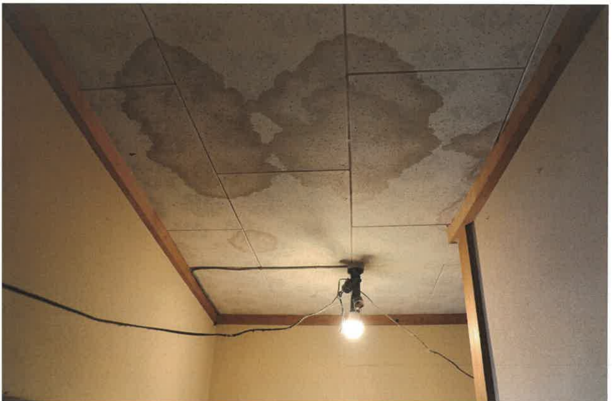
結合部分の天井雨染み
