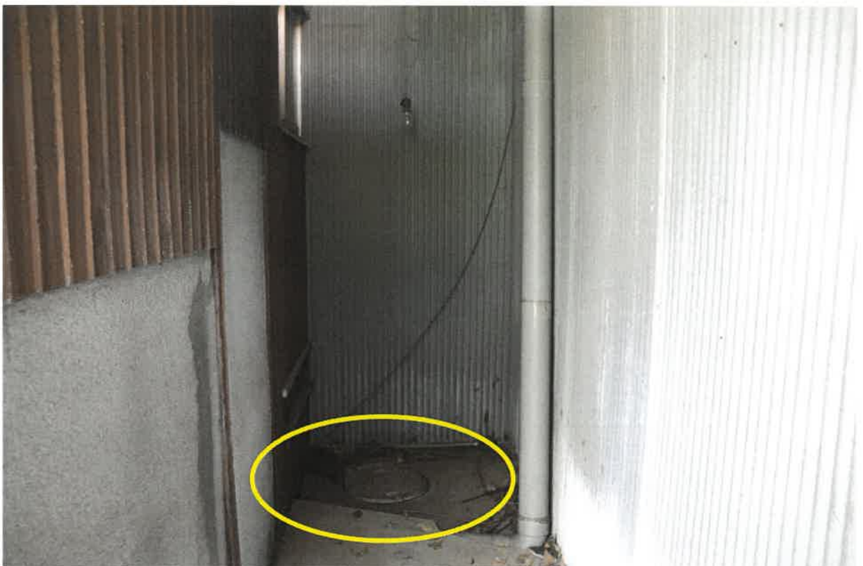
汲取り便槽（物件２・主である建物と物件３との結合部北側）
