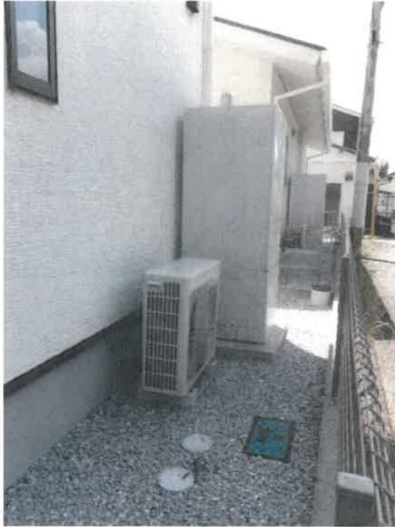
(写真3) 売却対象物件(従物)であるエコキュート
