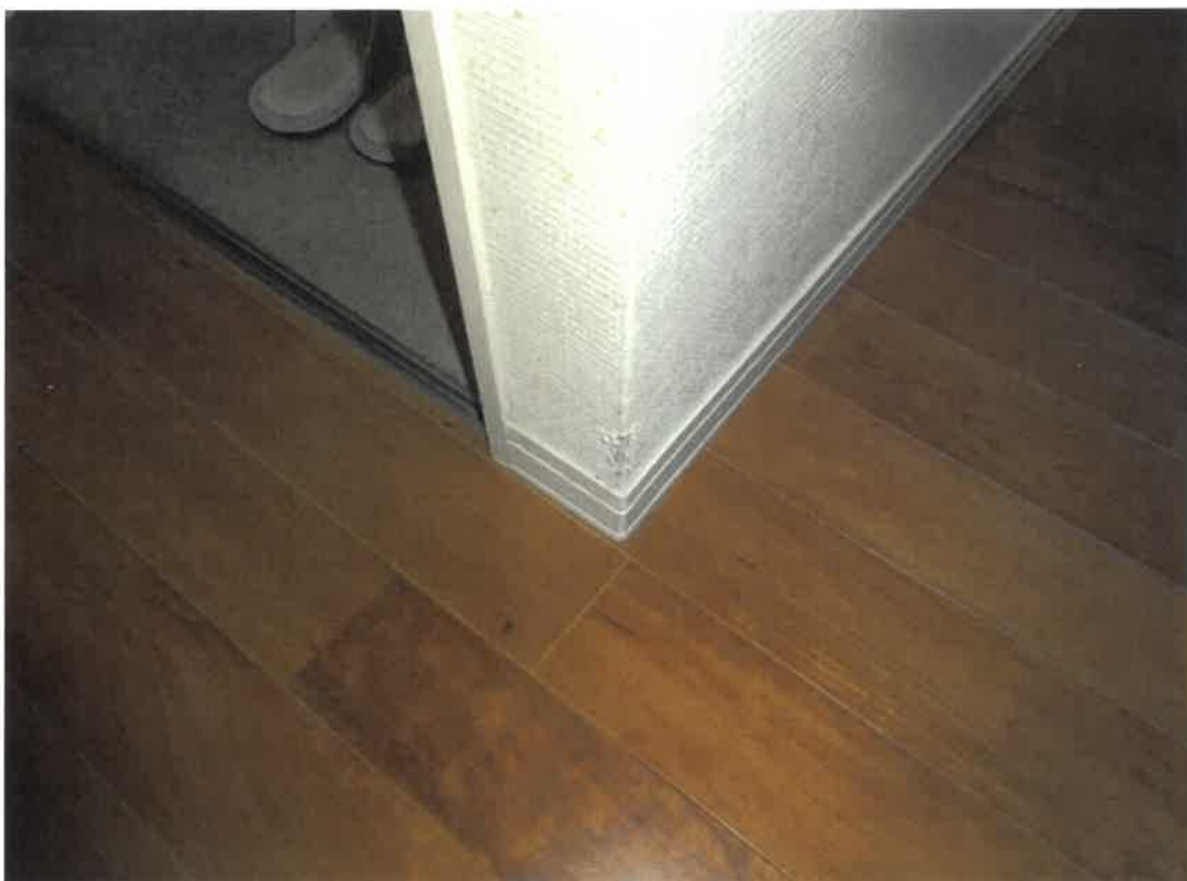
物件2（主である建物） 内壁の損傷
