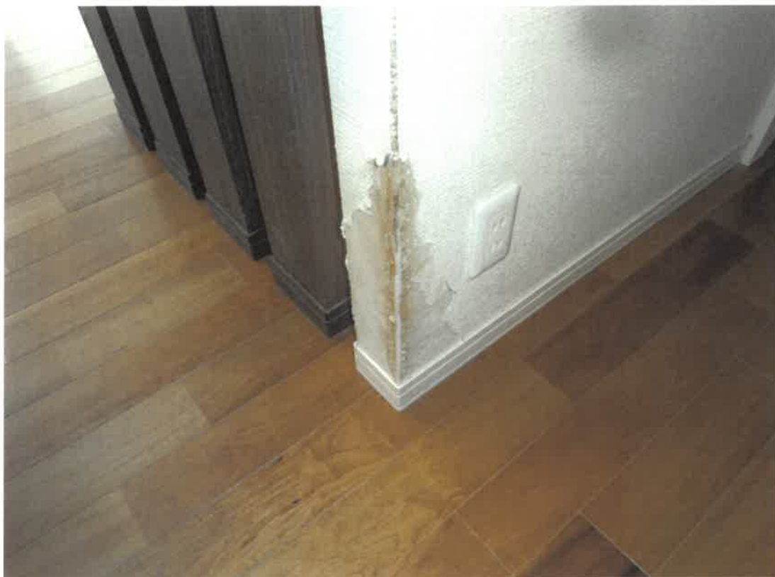
物件2（主である建物） 内壁の損傷
