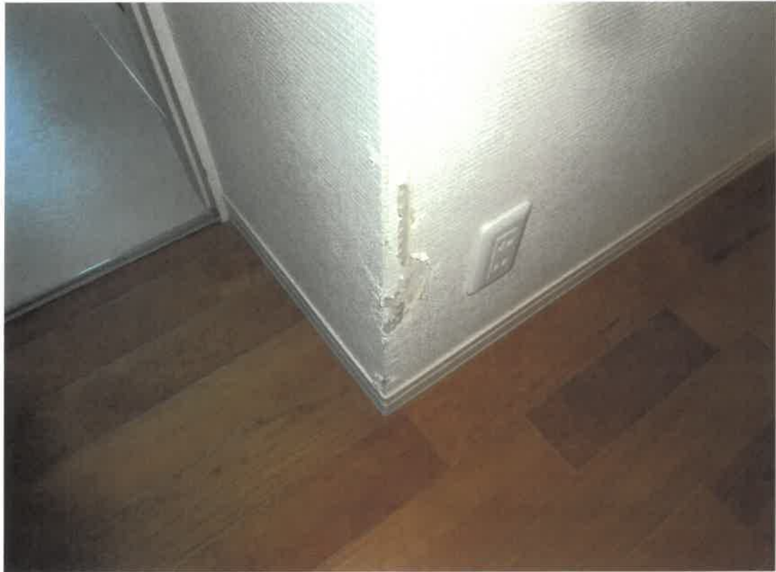
物件2（主である建物） 内壁の損傷
